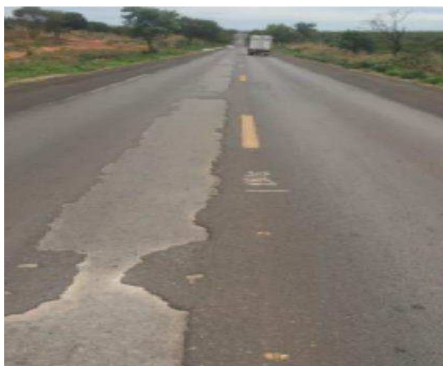
Figura 6 - Desagregação/Desgaste do revestimento
