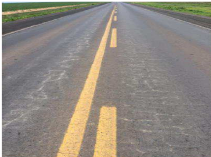
Figura 4 - Trincas e fissuras em revestimento asfáltico
