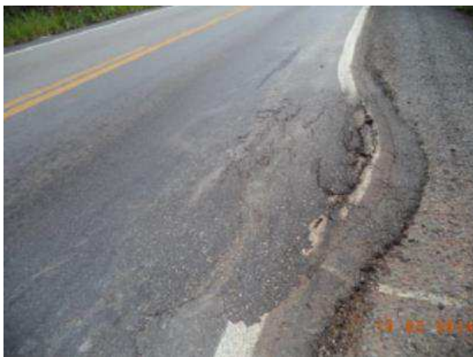
Figura 5 - Escorregamento do revestimento asfáltico
