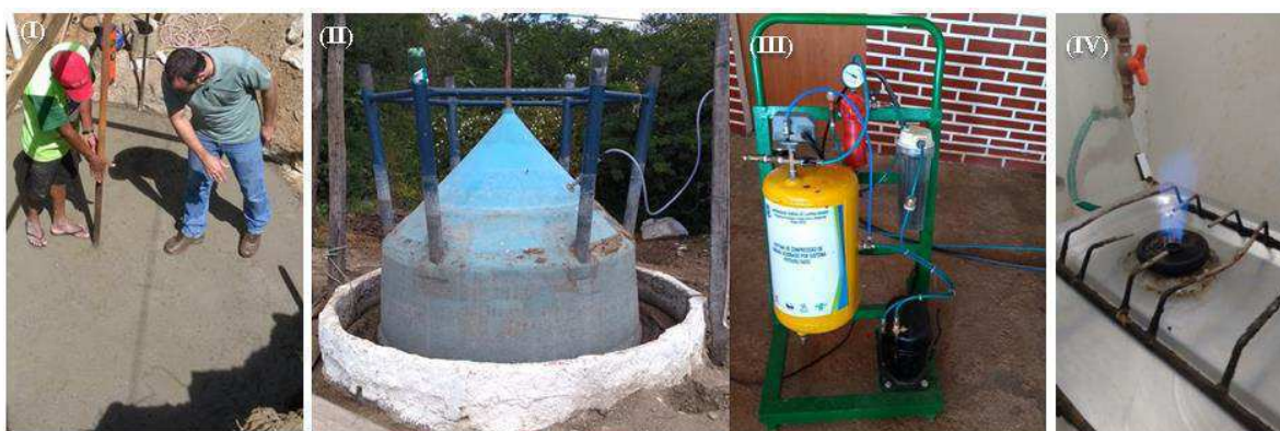
(I) Marcação, escavação e piso; (II) Funcionamento do biodigestor; (III) sistema de compressão instalado; (IV) Acionamento e queima do biogás
