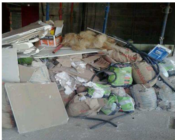
Figura 1. Materiais dispersos em meio à obra (empresa A).
