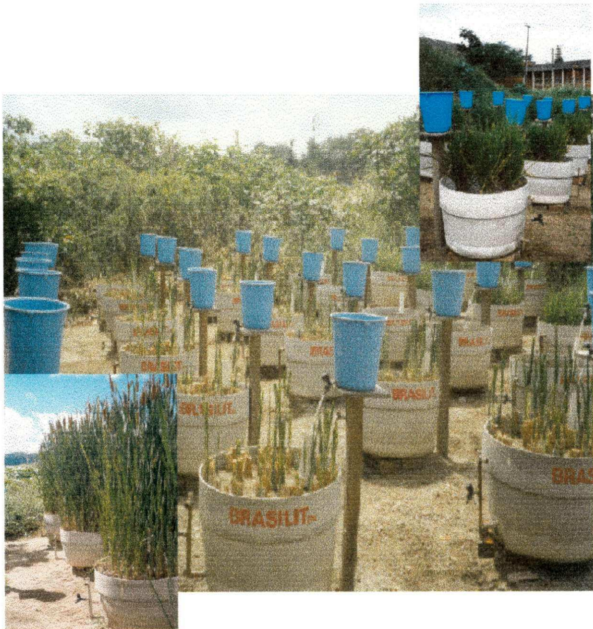
Figura 4.6 – Vista do sistema de terras úmidas construídas II, em fase de operação.
