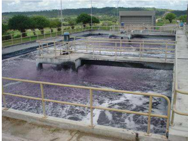
Figura 7 - Estação de Tratamento de Efluentes
