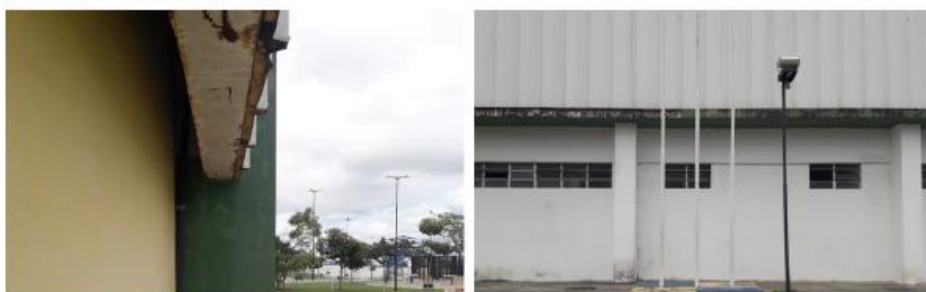
Figura 21 - Telha metálica tipo sanduíche nas vedações das fachadas | Fonte: Wilson Silva
