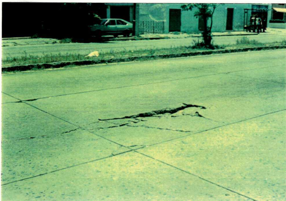
Fig. 58 - Av. Recife - Placa com Quebra Localizada (Vistoria em 1991).
