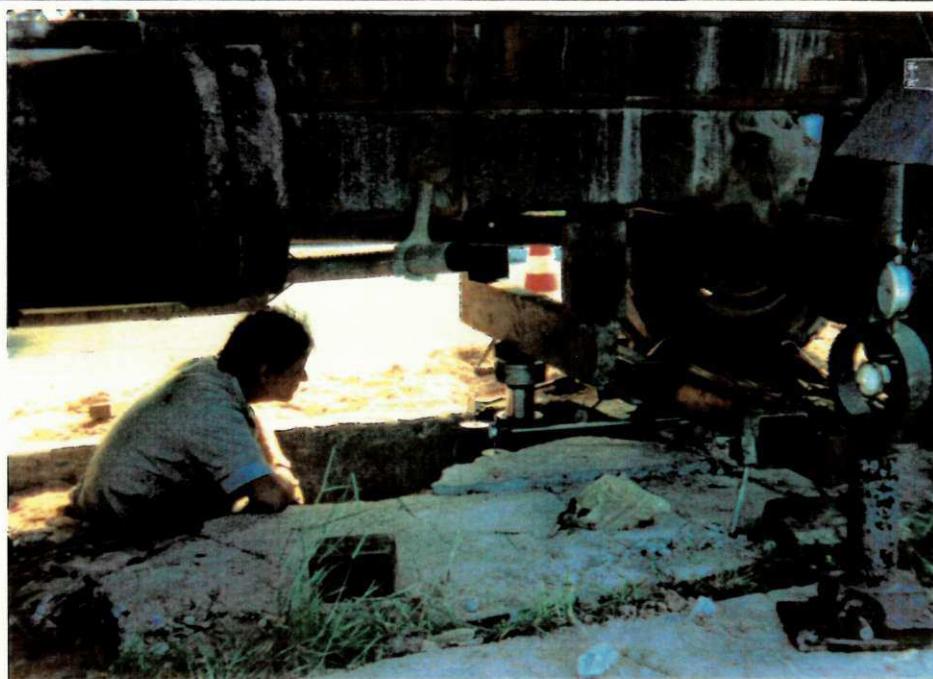
Fig. 25 - Av. Recife - Detalhe do Ensaio de Prova de Carga sobre Placas, Realizado no Canteiro Central (1991).
