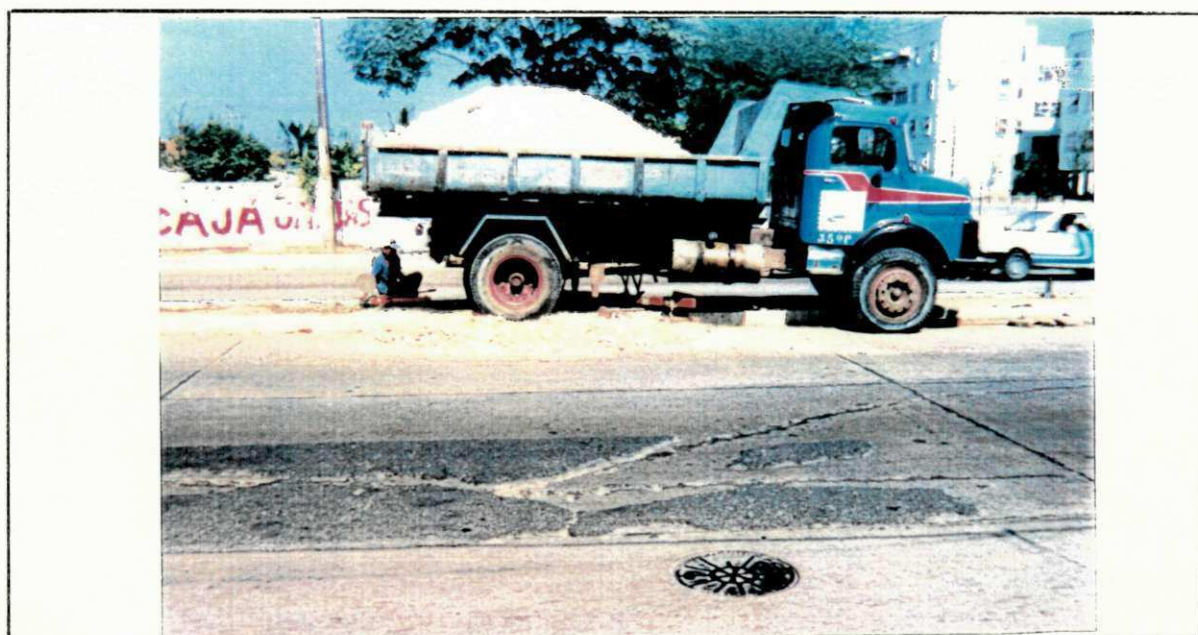
Fig. 56 - Av. Recife - Placa Quebrada ou Dividida, com Partes Cobertas com Asfalto (Vistoria em 1991). No Canteiro Central Vê-se a Execução de Prova de Carga so bre Placas.
