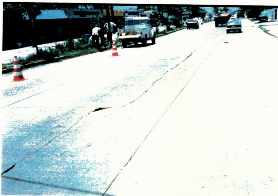
Fig. 54 - Av. Recife - Fissura Longit. (Faixa Central, LD) em Trecho com Discreto Assentamento do Pavimento, Vendo-se ainda Ausência de Selagem na Junta. (Vistoria em 1991). No Canteiro Central, ao Longe, Ens. Pressiom.
