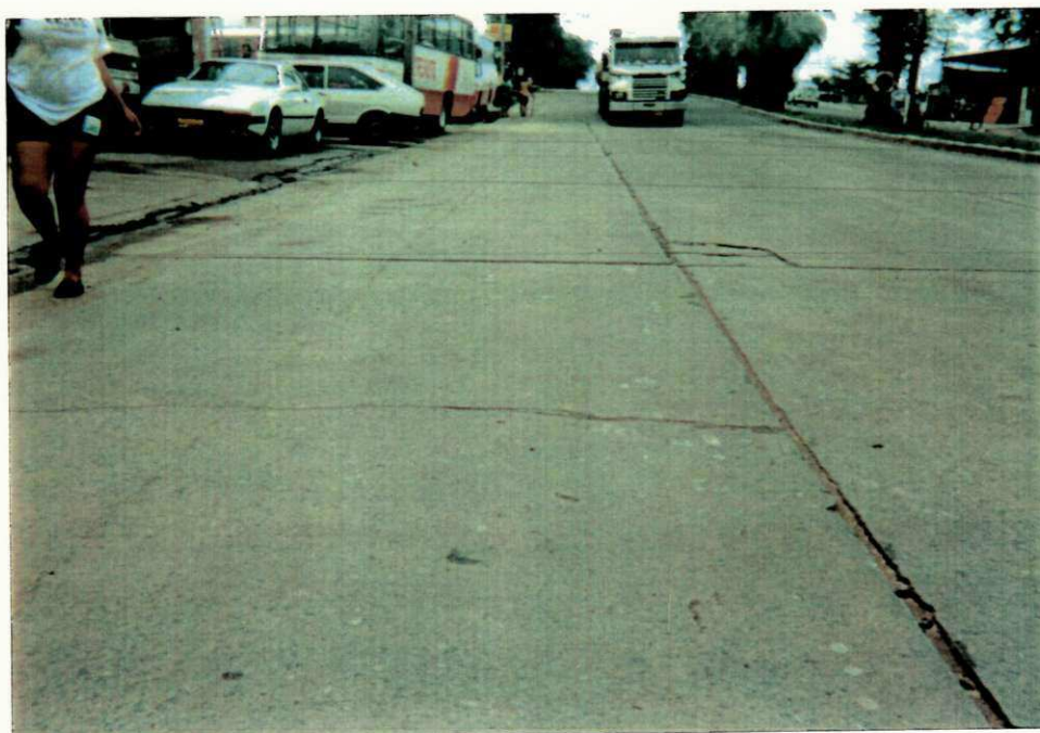
Fig. 59 - Av. Recife - Fissura Transversal, Quebra de Canto, Ausência de Selagem e Esborcinamento de Junta. (Vistoria em 1991).
