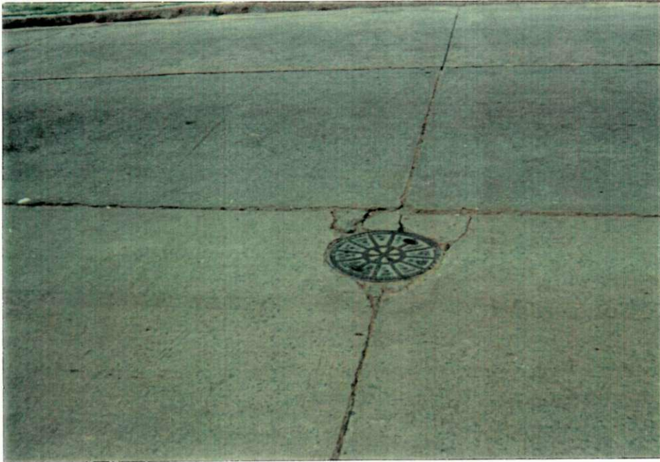
Fig. 60 - Av. Recife - Quebras de Canto Induzidas por Tampão de Galeria e Deficiência na Selagem das Juntas (Visitoria em 1991).
