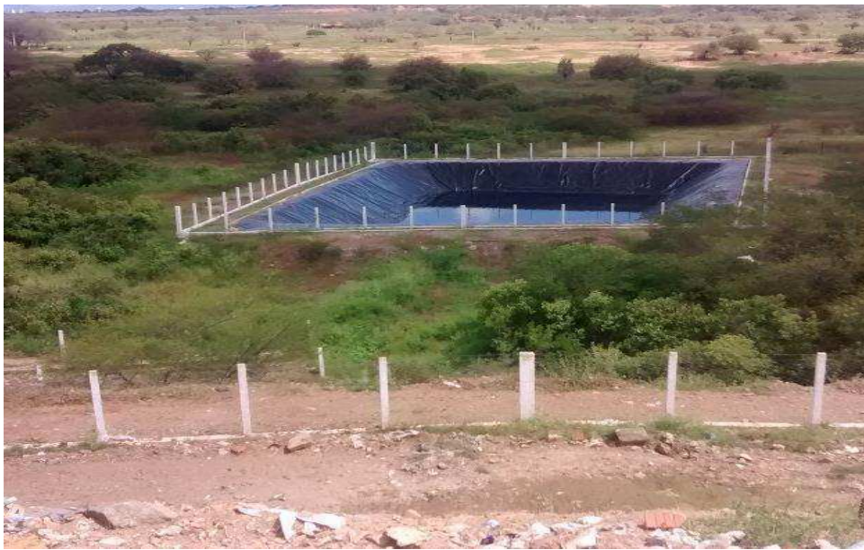
Figura 14. Lagoa contendo a manta de PVA e falta de encanação para retrain os gases e seus odores Fonte: O autor 2018.
