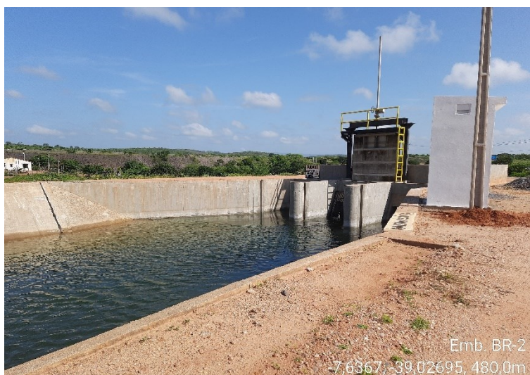
Foto 18 - Comporta de controle de vazão no emboque do sifão invertido.
