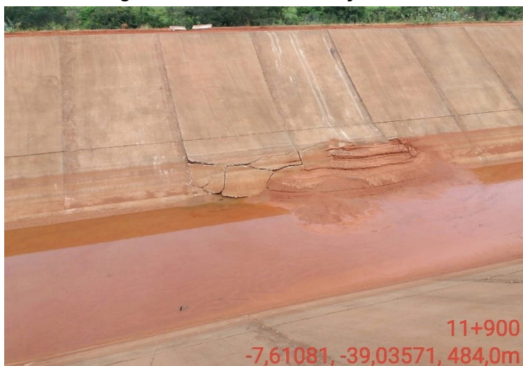
Foto 8 - Escorregamento de solo na seção hidráulica do canal.
