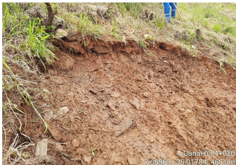
Foto 9 - Talude do dique do canal saturado.
