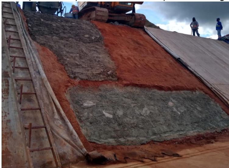
Foto 14 - Reparo do dique do canal – recalque e escorregamento.
