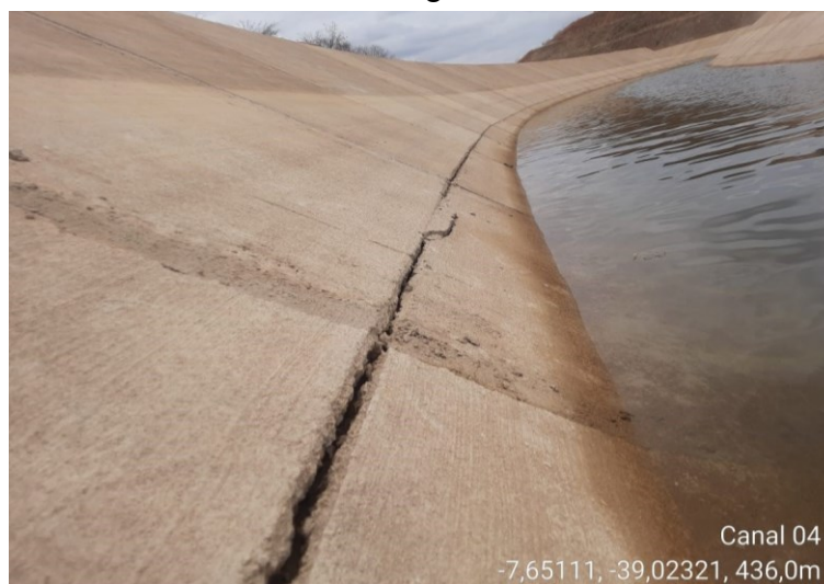
Foto 6 - Junta longitudinal trincada.
