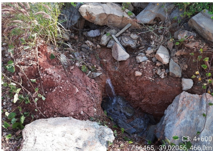
Foto 10 - Escoamento de água no maciço (dique) do canal.
