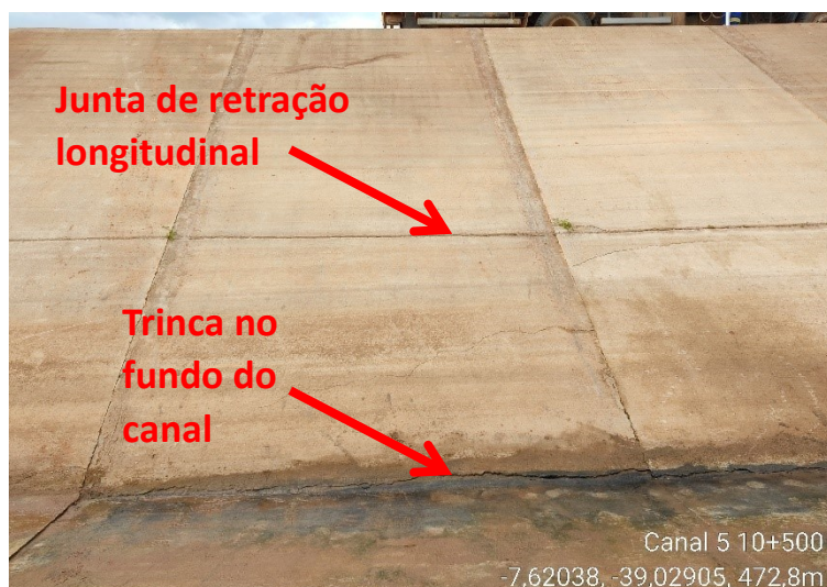
Foto 5 - Fundo do canal fissurado.
