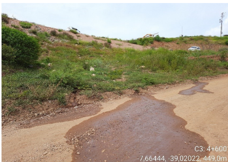
Foto 3 - Água de vazamentos cruzando acessos às propriedades rurais.
