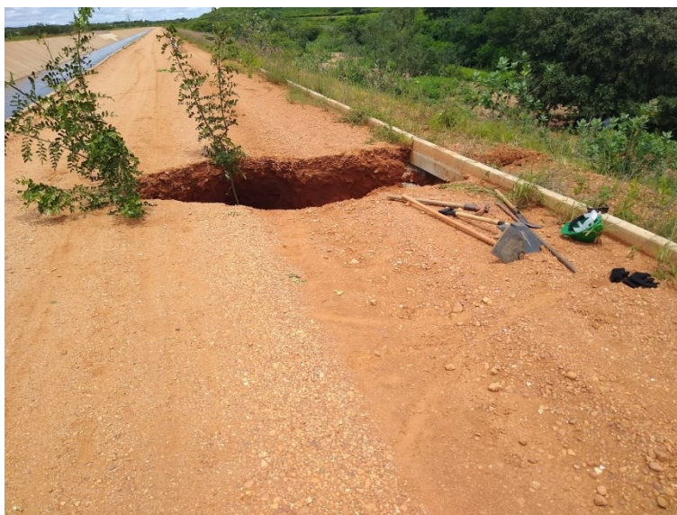
Foto 7 - Recalque na berma do canal.
