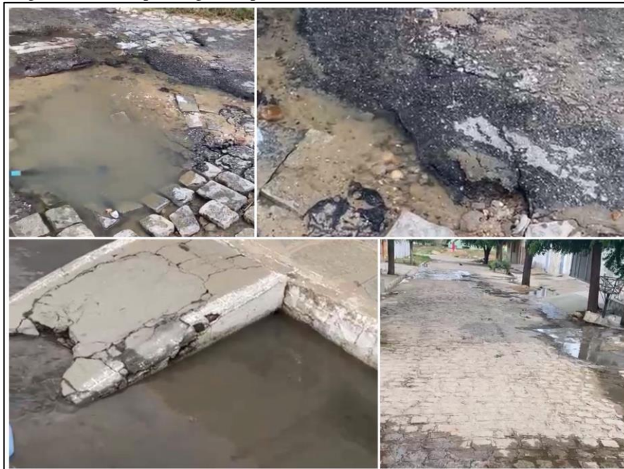
Figura 35 - Exemplo de galeria pluvial estourada em rua do bairro São Sebastião.
