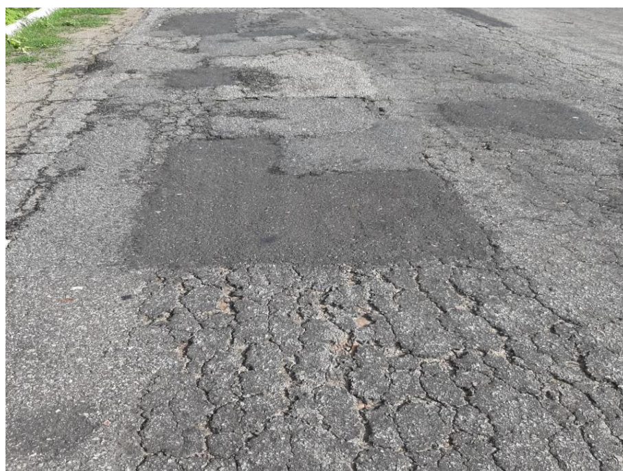
Figura 20- Trincas Couro de Jacaré e Remendos
