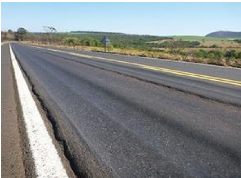
Figura 8 - Afundamento Tipo Plástico
