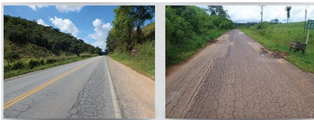
Figura 7- Trinca tipo Couro de Jacaré
