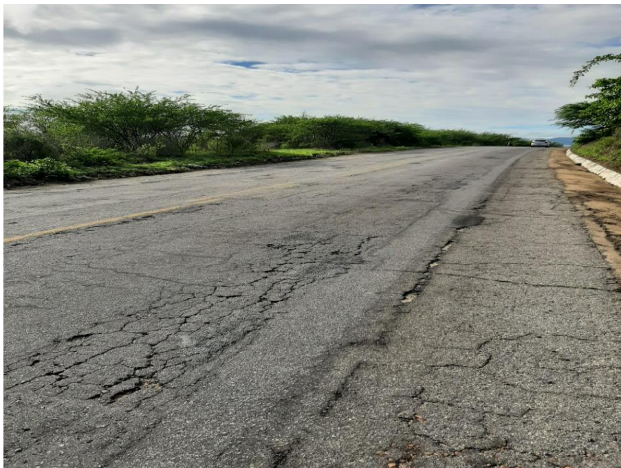
Figura 19 - Trincas isoladas, trincas couro de jacaré
