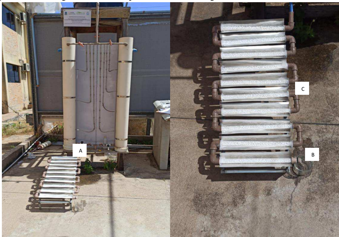
Figura 16 - Visão geral do sistema para tratamento de água.
