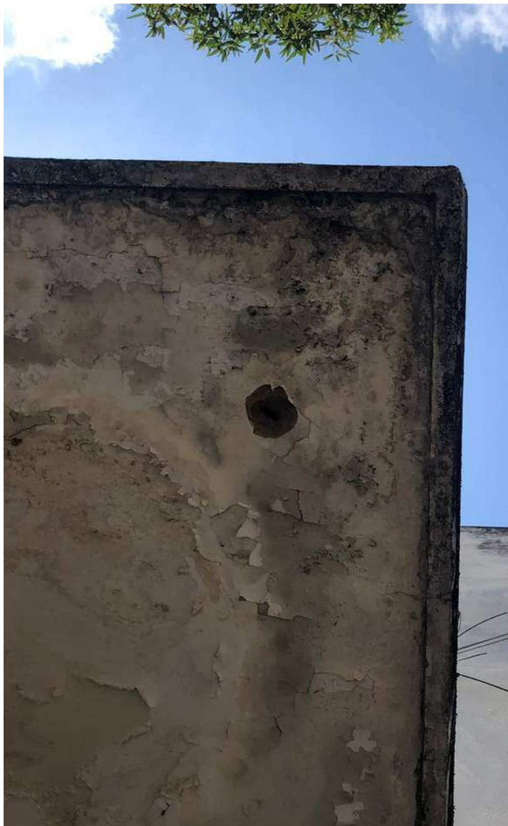
UMIDADE DESCENDENTE NA MARQUISE DA FACHADA NORTE. FONTE: MIRELLA DARLANA (2023)
