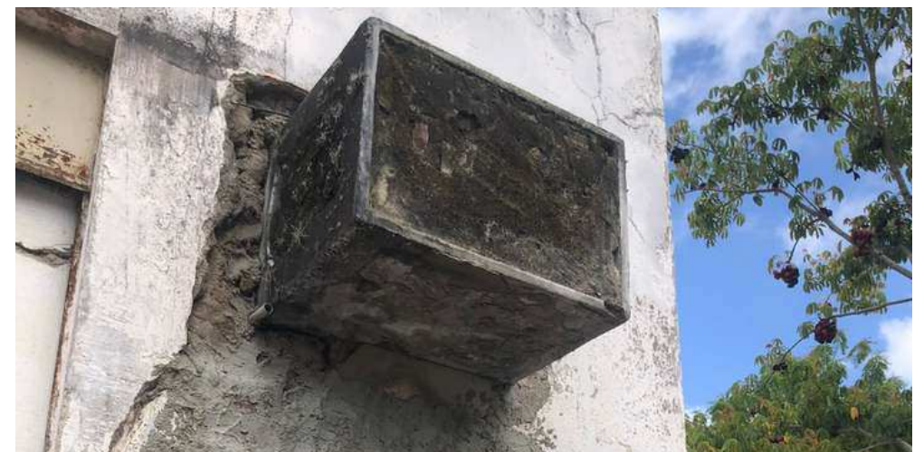
ESPAÇO PARA CONDESADORA NA FACHADA LESTE. FONTE: MIRELLA DARLANA (2023)
