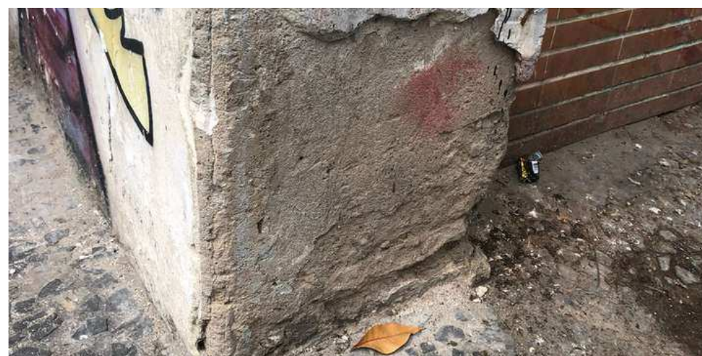
DESAGREGAÇÃO NO PÓRTICO DA FACHADA NORTE. FONTE: MIRELLA DARLANA (2023)
