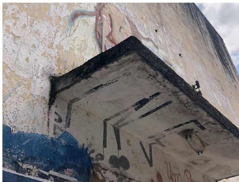
UMIDADE DESCENDENTE NA MARQUISE DA FACHADA SUL. FONTE: MIRELLA DARLANA (2023)
