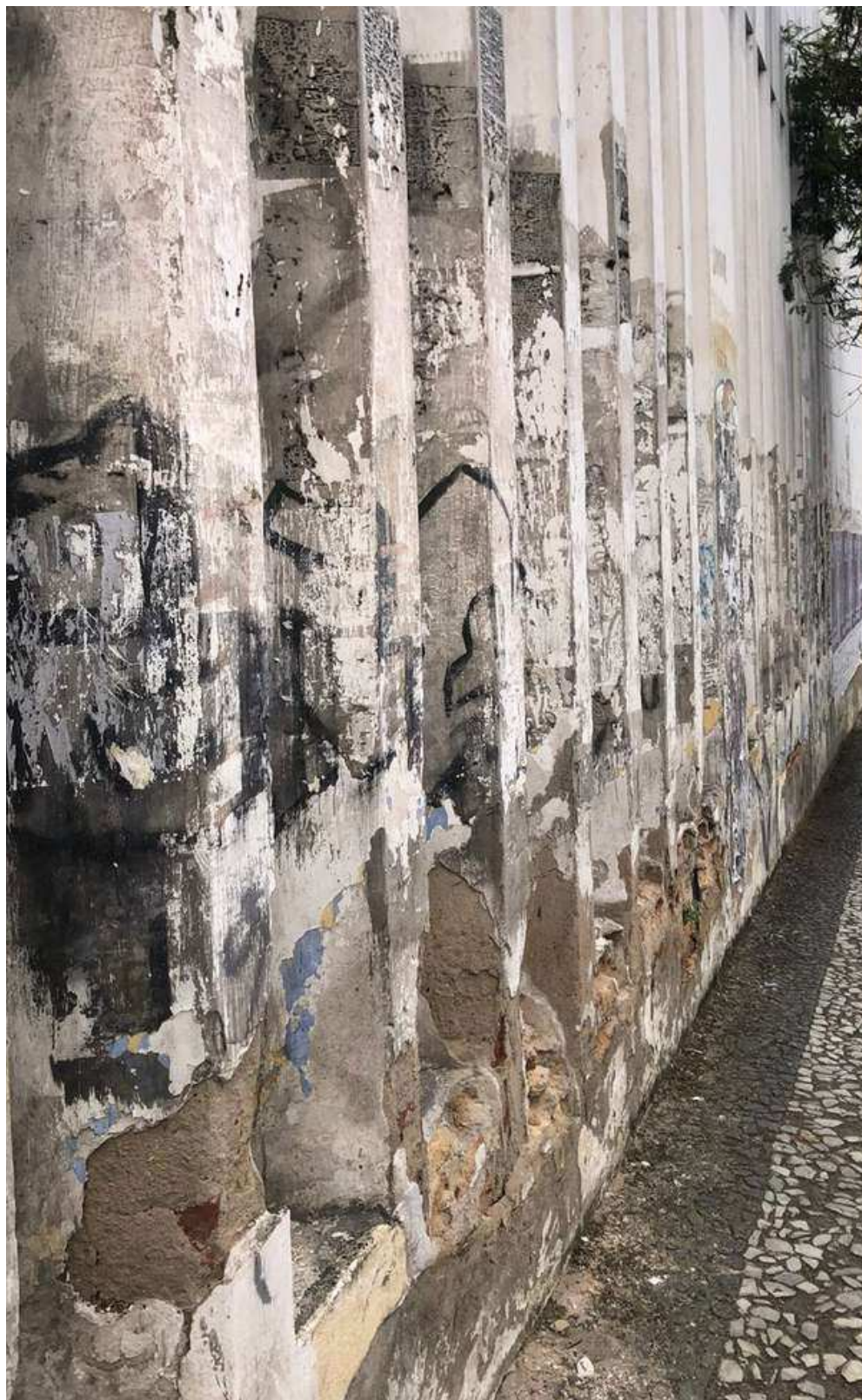
DESAGREGAÇÃO NA BASE DO BRISE DA FACHADA OESTE. FONTE: MIRELLA DARLANA (2023)
