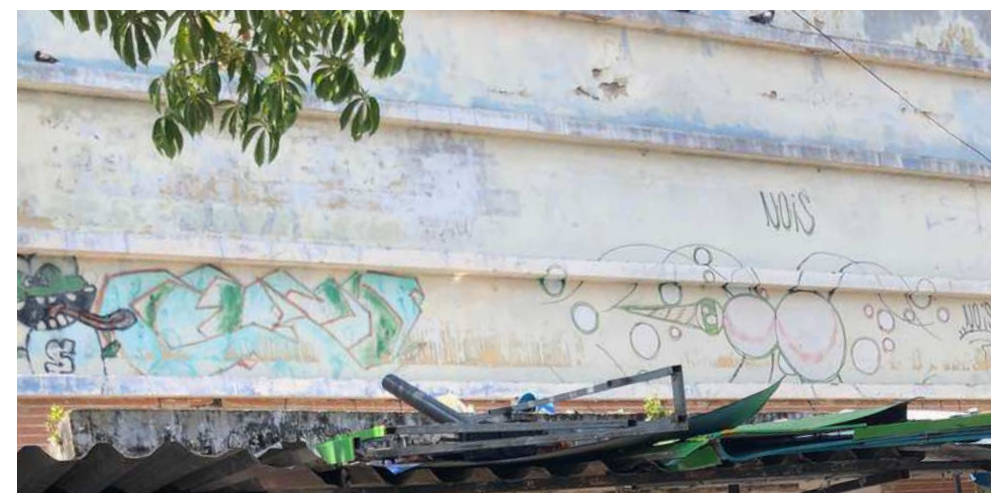
PIXAÇÕES NA FACHADA NORTE. FONTE: MIRELLA DARLANA (2023)
