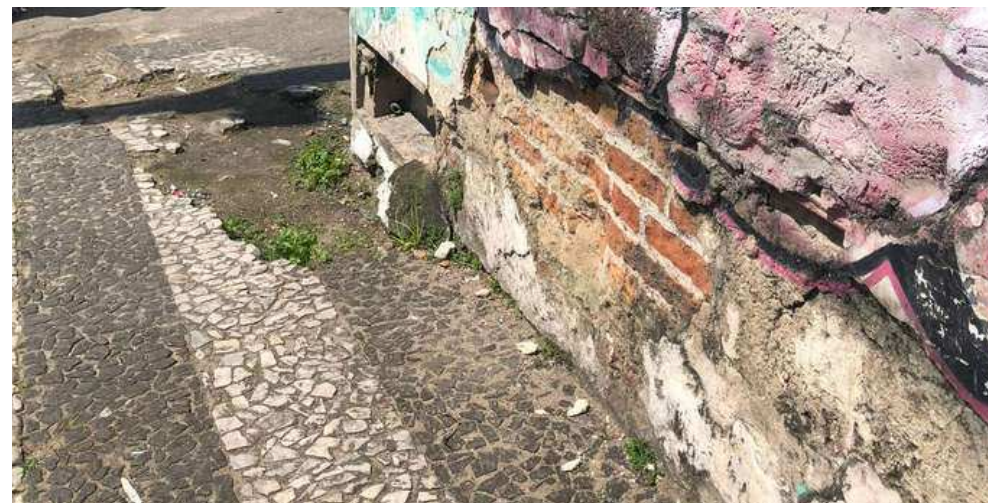
DESAGREGAÇÃO NA FACHADA LESTE. FONTE: MIRELLA DARLANA (2023)
