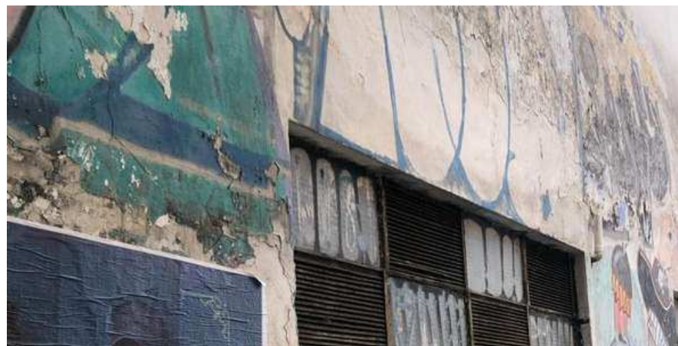
DESCASCAMENTO NA FACHADA OESTE. FONTE: MIRELLA DARLANA (2023)
