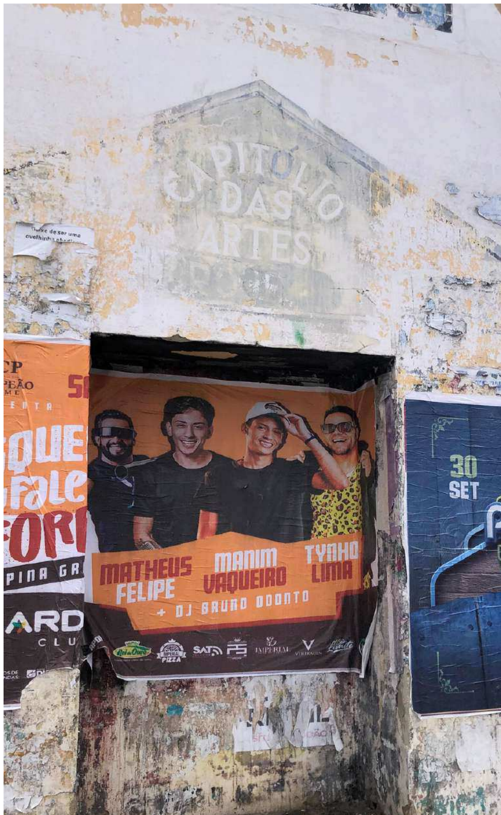
OBSTRUÇÃO DE ABERTURA POR CONSTRUÇÃO POSTERIOR E PROPAGANDA NA FACHADÀ SUL. FONTE: MIRELLA DARLANA (2023)
