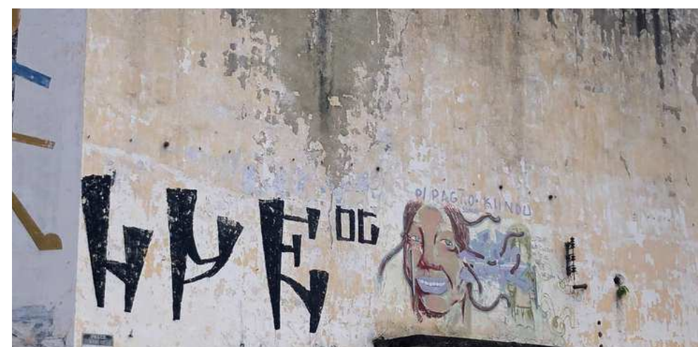
PIXAÇÕES NA FACHADA SUL. FONTE: MIRELLA DARLANA (2023)
