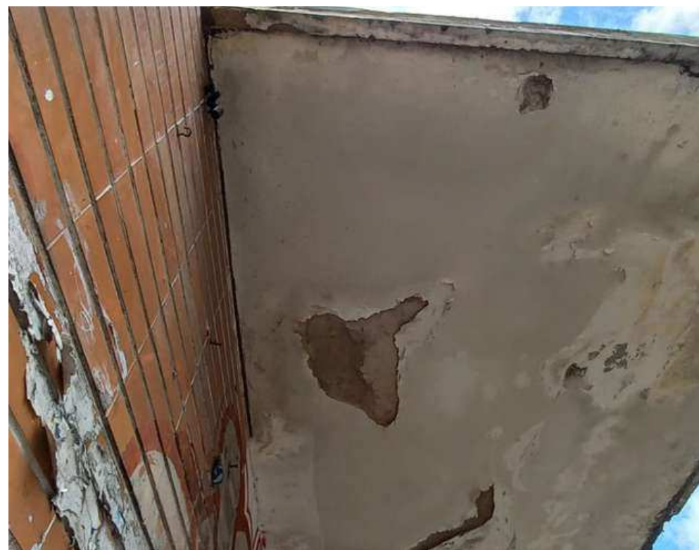
EFLORESCÊNCIA NA MARQUISE DA FACHADA NORTE. FONTE: MIRELLA DARLANA (2023)
