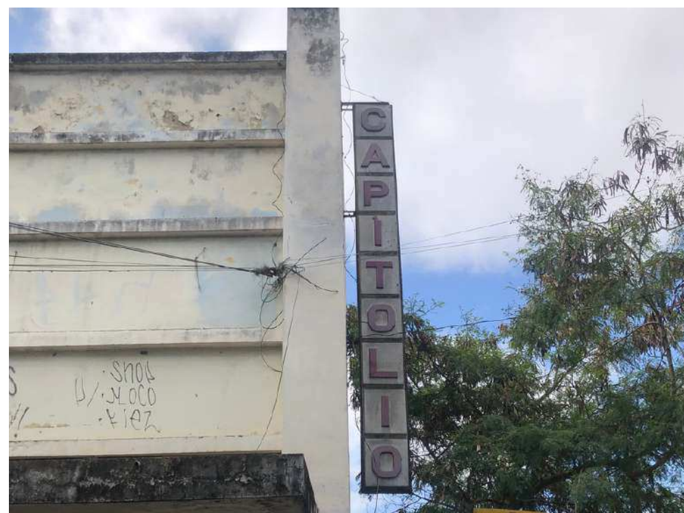
EFLORESCÊNCIA EM ELEMENTOS DA FACHADA NORTE. FONTE: MIRELLA DARLANA (2023)
