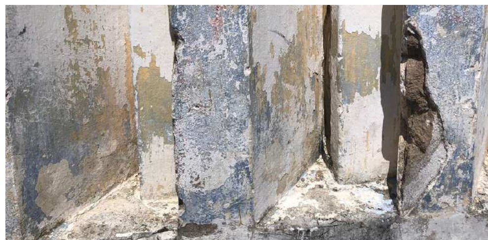
DESAGREGAÇÃO NO BRISE DA FACHADA LESTE. FONTE: MIRELLA DARLANA (2023)
