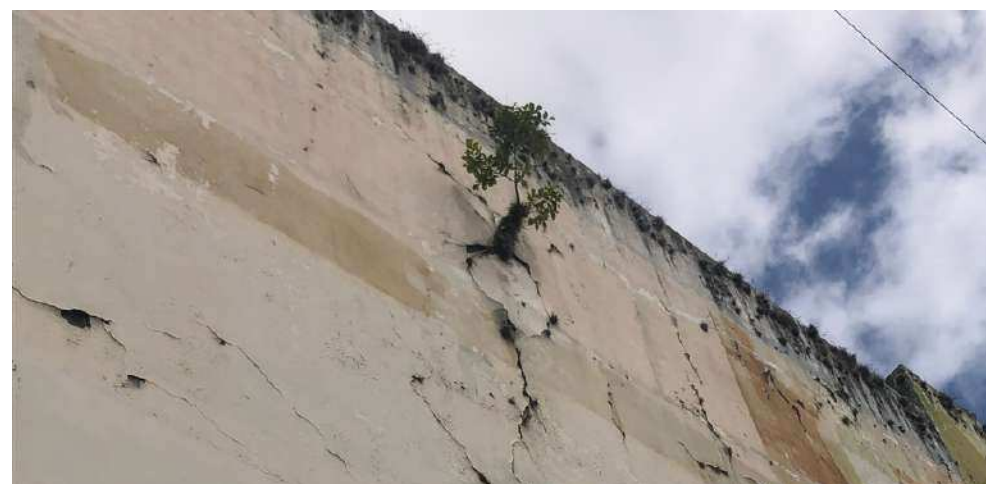
CROSTA NEGRA NA FACHADA LESTE. FONTE: MIRELLA DARLANA (2023)
