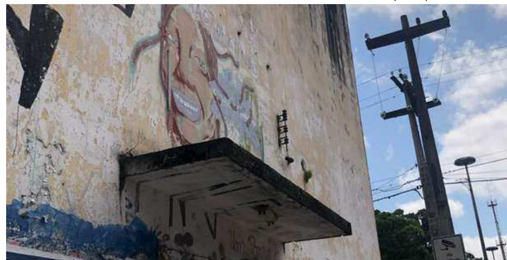
DESCASCAMENTO NA FACHADA SUL. FONTE: MIRELLA DARLANA (2023)
