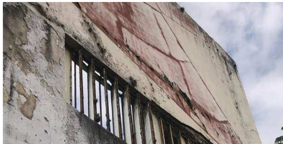
DESCASCAMENTO NA FACHADA LESTE. FONTE: MIRELLA DARLANA (2023)
