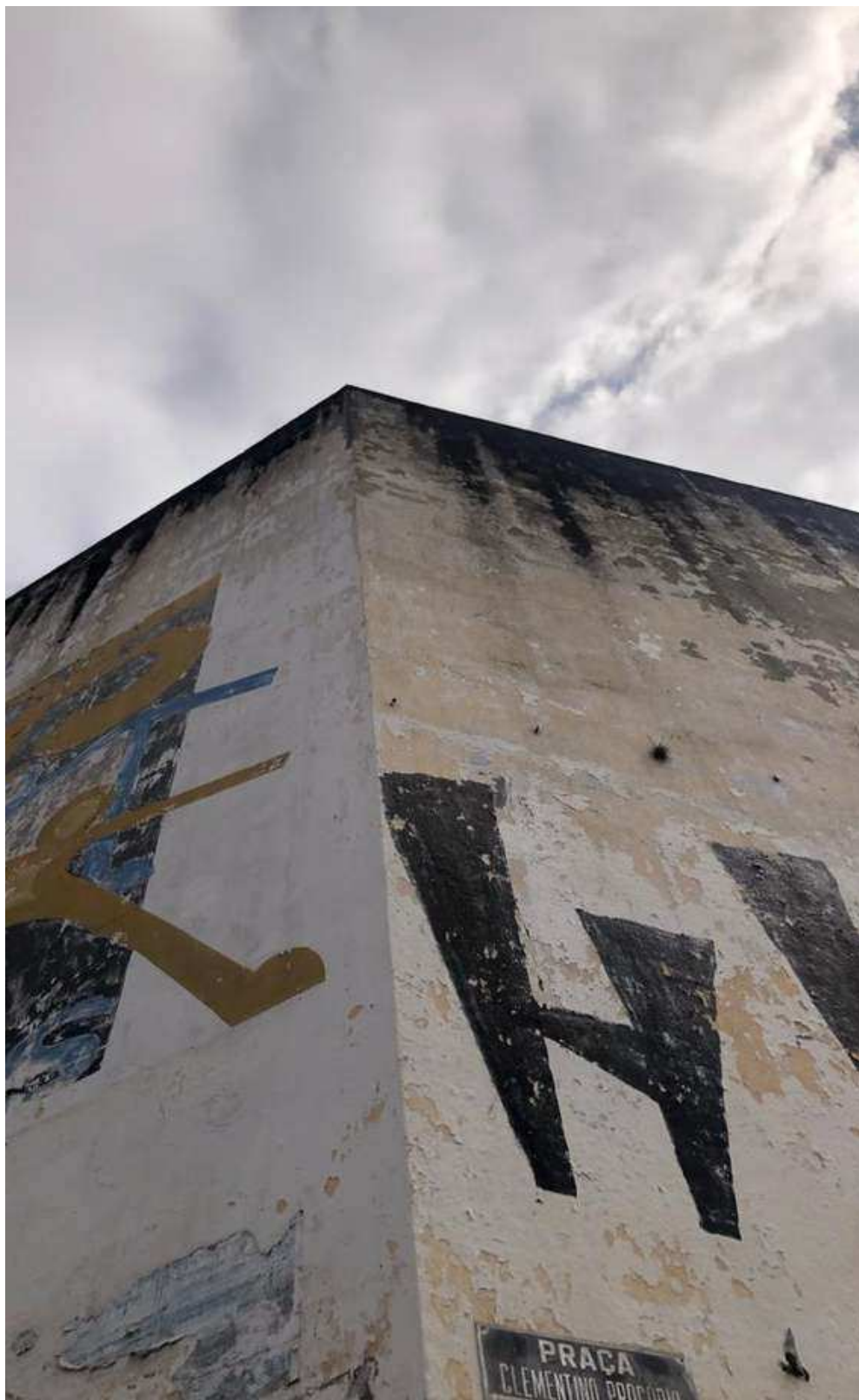
DESCASCAMENTO NA FACHADA SUL. FONTE: MIRELLA DARLANA (2023)
