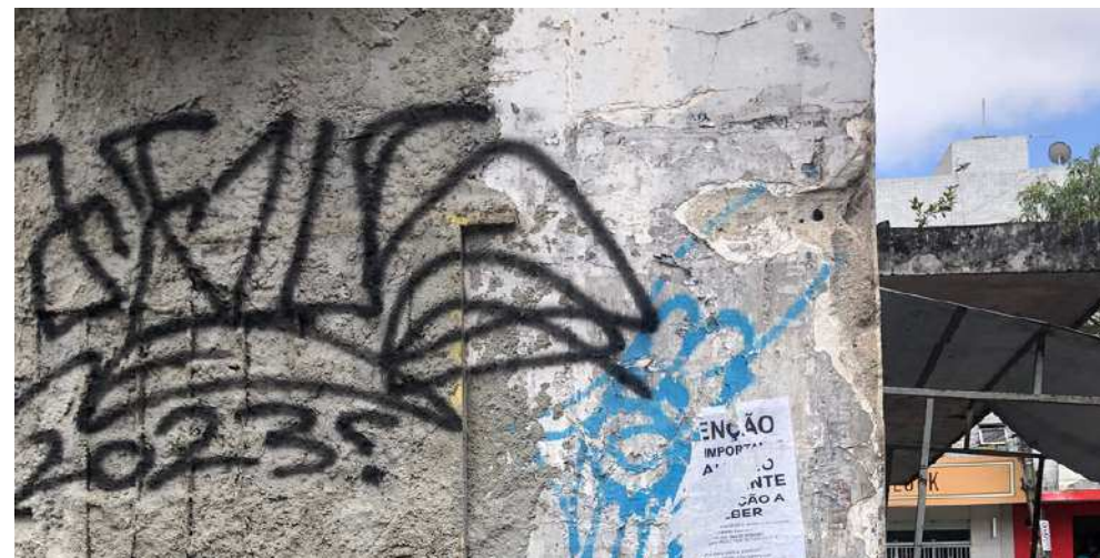
PIXAÇÕES NA FACHADA LESTE. FONTE: MIRELLA DARLANA (2023)
