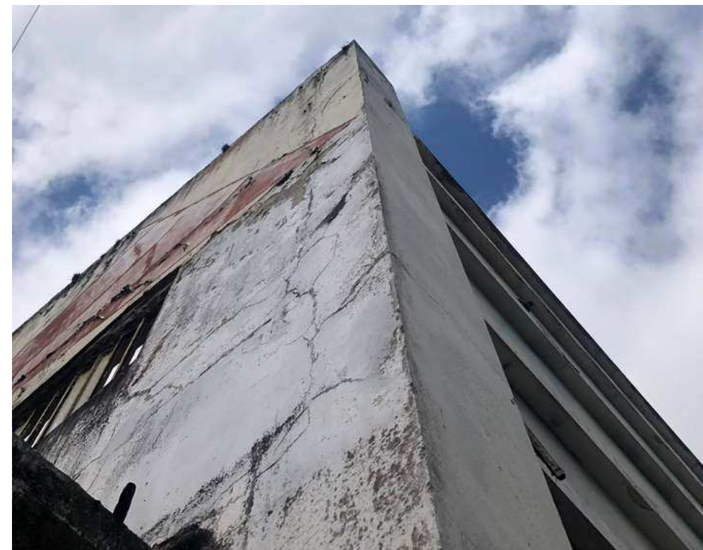
FISSURAS NA FACHADA LESTE. FONTE: MIRELLA DARLANA (2023)
