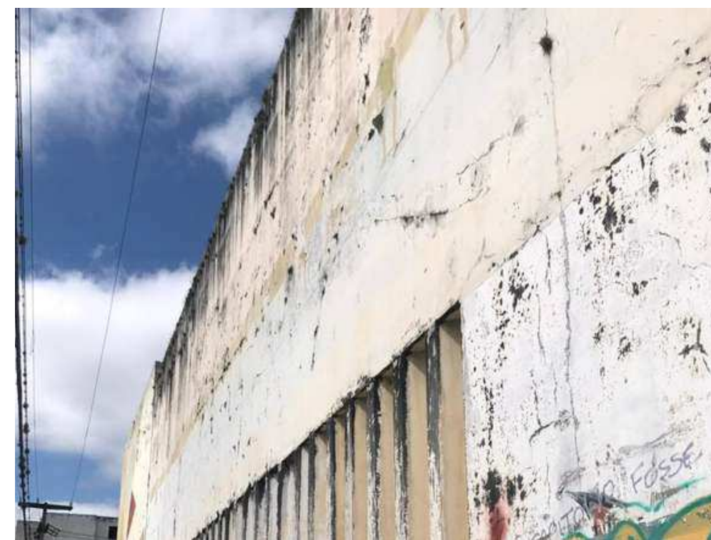
FISSURAS NA FACHADA LESTE. FONTE: MIRELLA DARLANA (2023)
