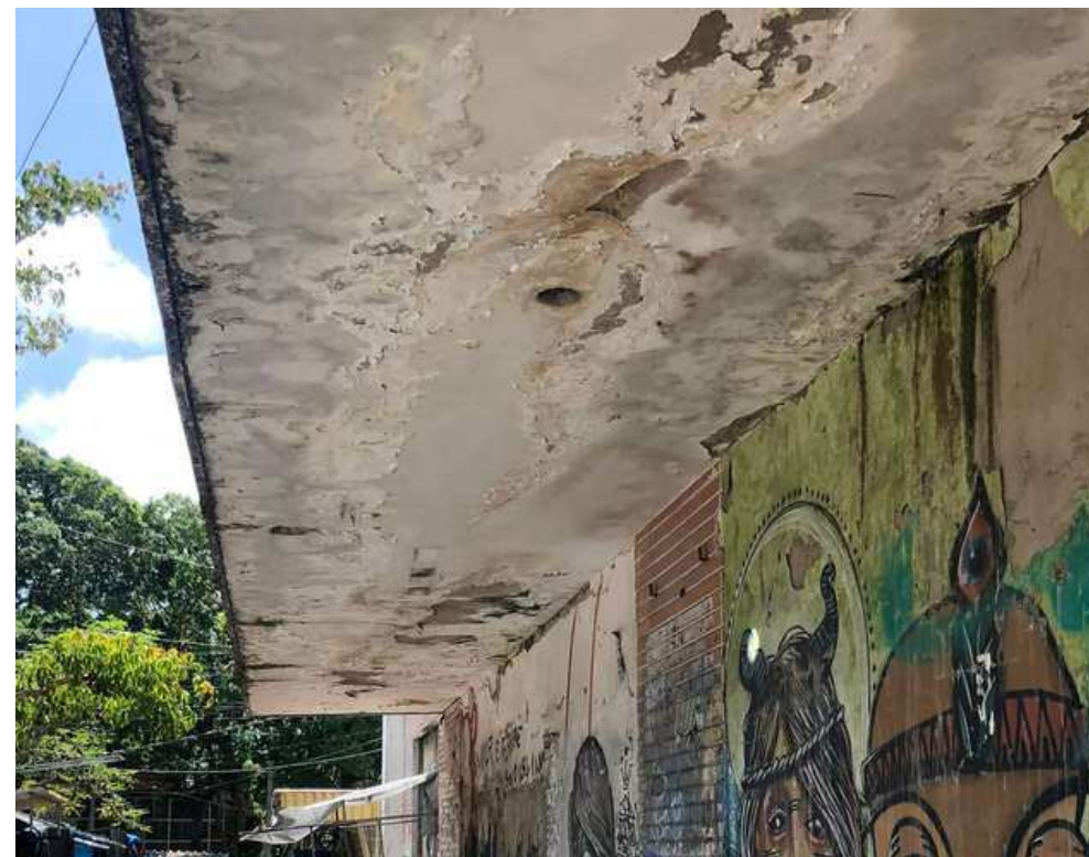
UMIDADE DESCENDENTE NA MARQUISE DA FACHADA NORTE. FONTE: MIRELLA DARLANA (2023)
