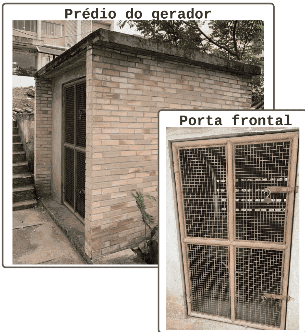
Figura 45 – Foto do prédio em que o gerador está localizado.
