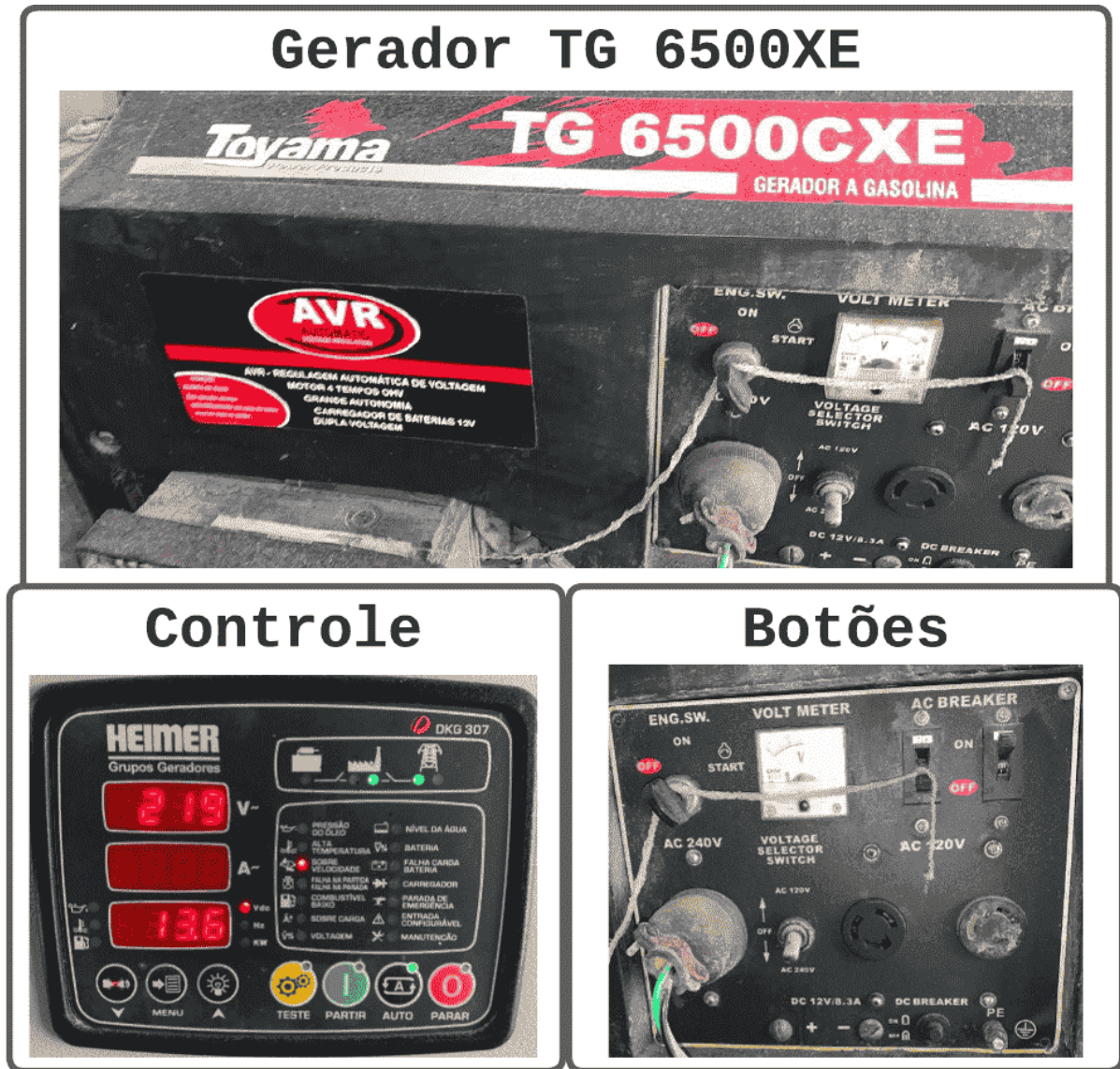
Figura 44 – Gerador e seu sistema de controle.
