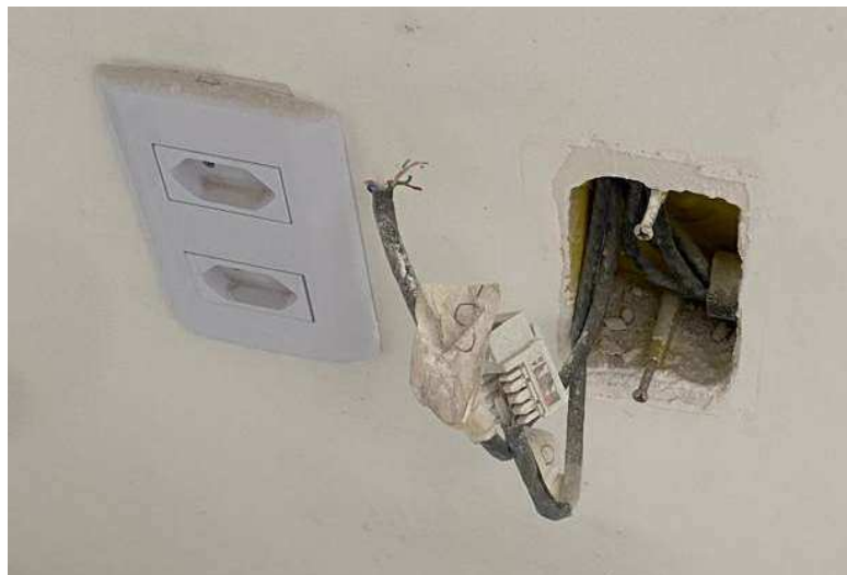
Figura 3 - Ponto de rede com fios expostos
