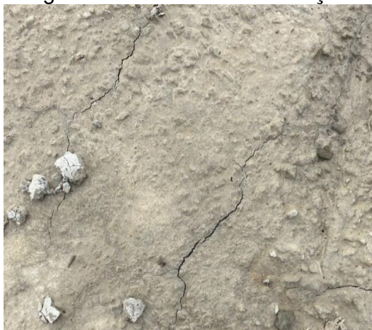
Figura 28 – Fissuras de retração.
