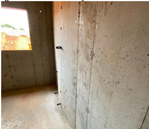
Figura 30 – Deformações nas Paredes.
