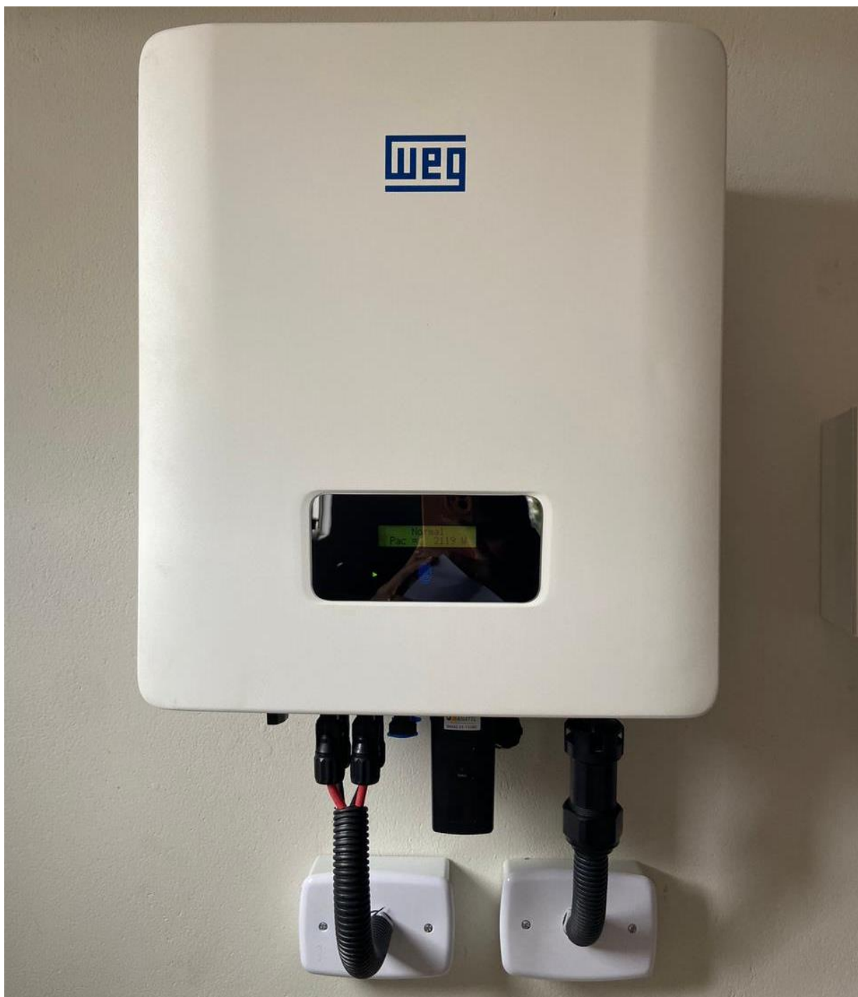
Figura 27 – Fotografia de inversor WEG modelo SIW200G M070 W0 instalado.
