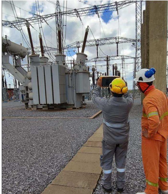
Figura 11 - Ultrassonografia no transformador de 33MVA
