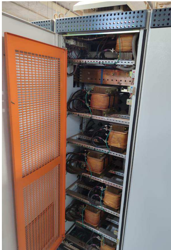
Figura 19 - Reatores de dissintonia de um dos bancos de capacitores
