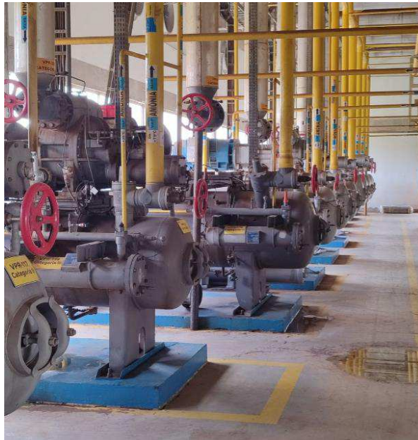
Figura 6 - Sala de máquinas da refrigeração da planta de abate dos suínos
