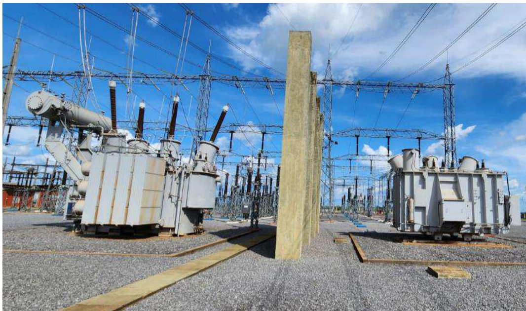
Figura 3 - Subestação principal 230 KV
