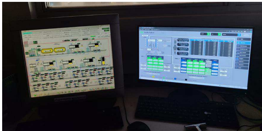
Figura 7 – Supervisório da refrigeração da planta de abate dos suínos.
