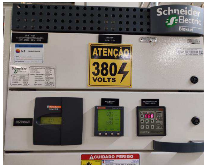
Figura 18 - Controlador, Multimetedor de um dos bancos de capacitores
