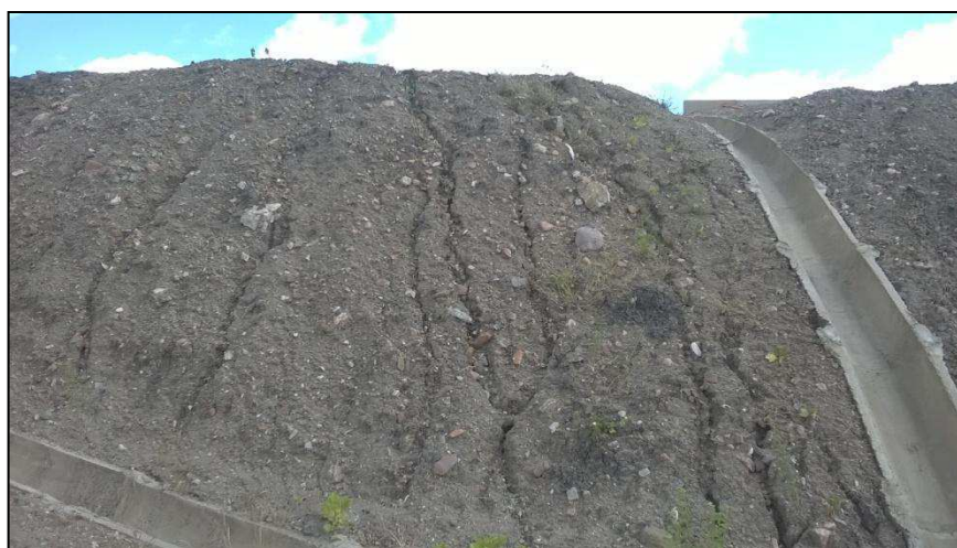
Figura 57 - Erosão do solo.
