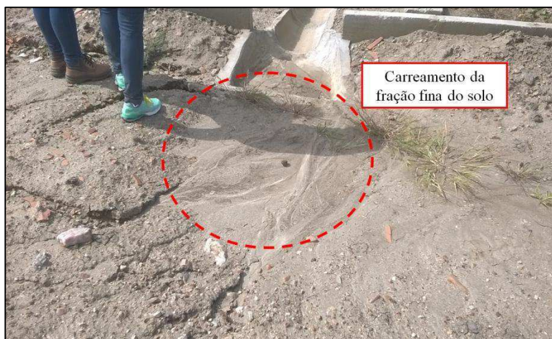
Figura 54 - Carreamento dos finos contidos no solo.
