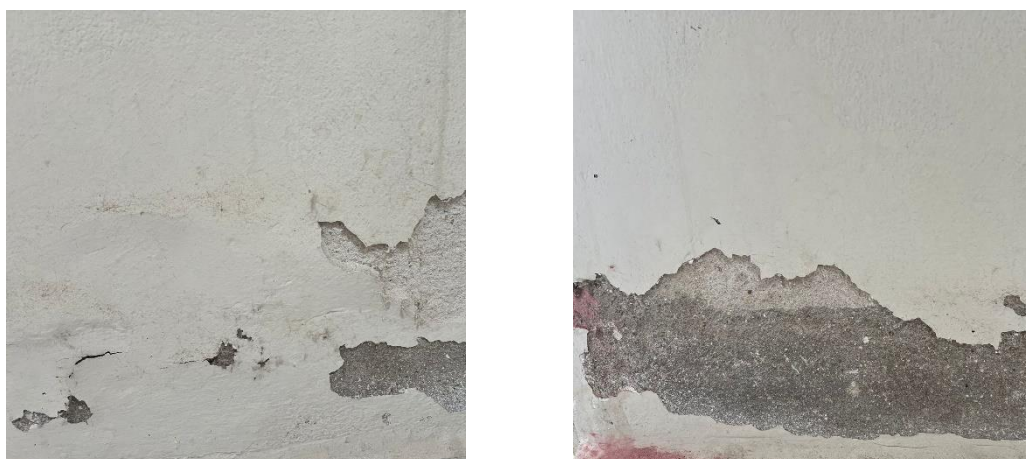
Figura 12 – Descascamento de pintura. Fonte: Autor (2023).
