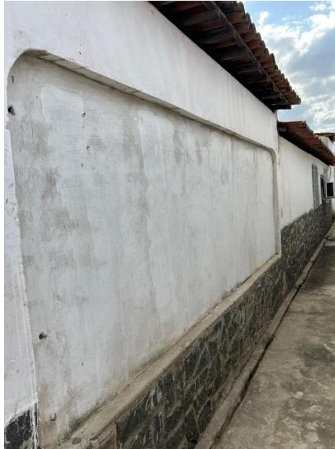
Figura 20 – Fissura originada pelo encunhamento da alvenaria. Fonte: Autor (2023).
