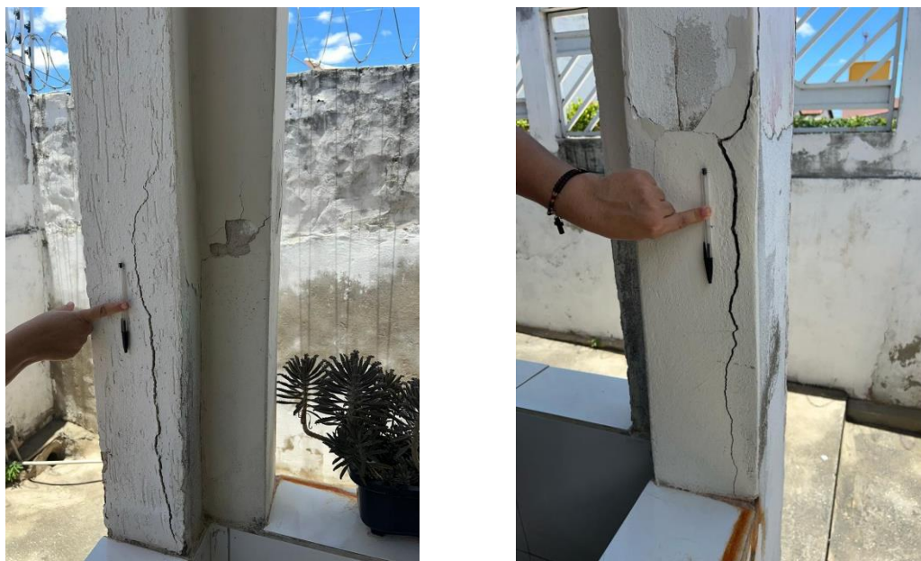
Figura 16 – Fissura em elemento estrutural pilar. Fonte: Autor (2023).
