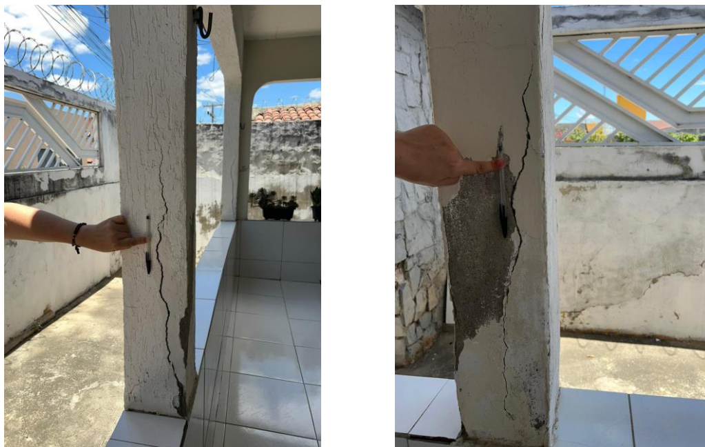
Figura 15 – Fissura em elemento estrutural pilar. Fonte: Autor (2023).
