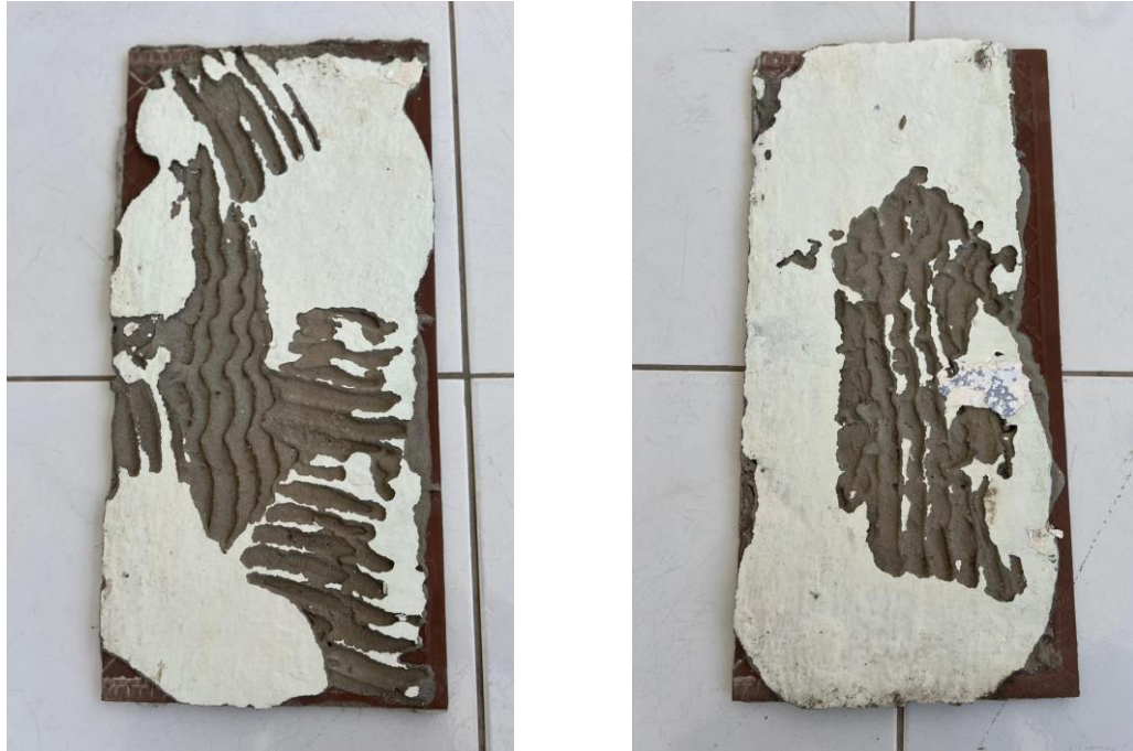
Figura 8 – Peças cerâmicas deslocadas. Fonte: Autor (2023).
