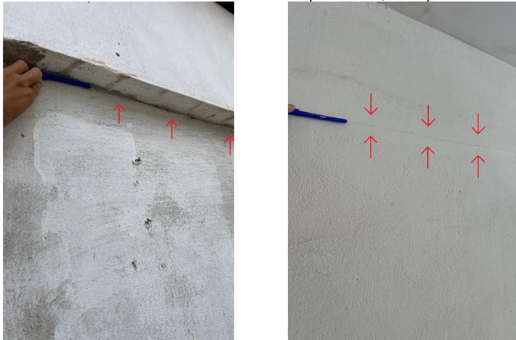
Figura 19 – Fissura originada pelo encunhamento da alvenaria. Fonte: Autor (2023).
