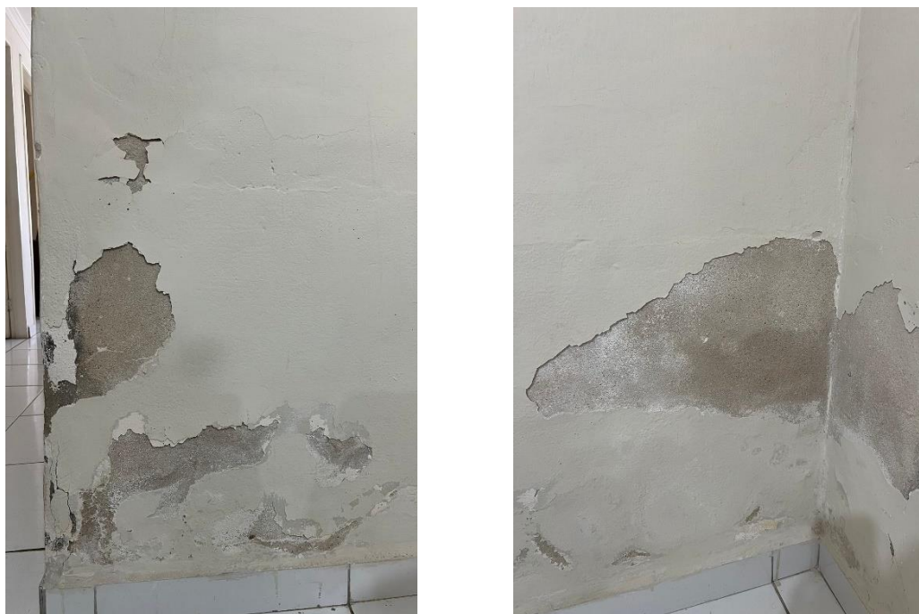
Figura 11 – Descascamento de pintura. Fonte: Autor (2023).
