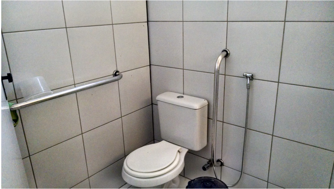
Foto 12 – Banheiro adaptado da residência feminina
