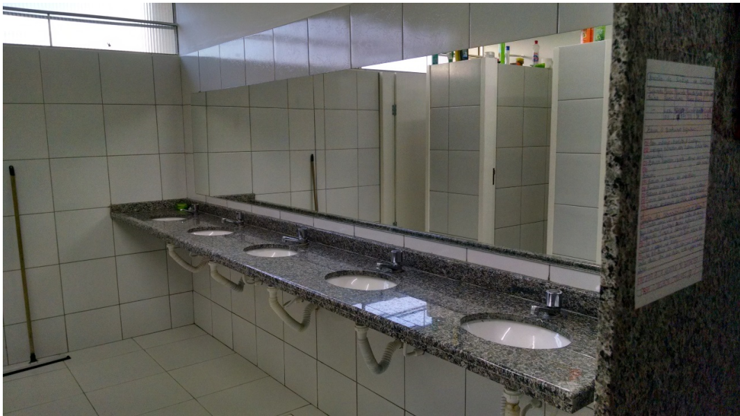
Foto 15 – Lavatório do banheiro da residência masculina
