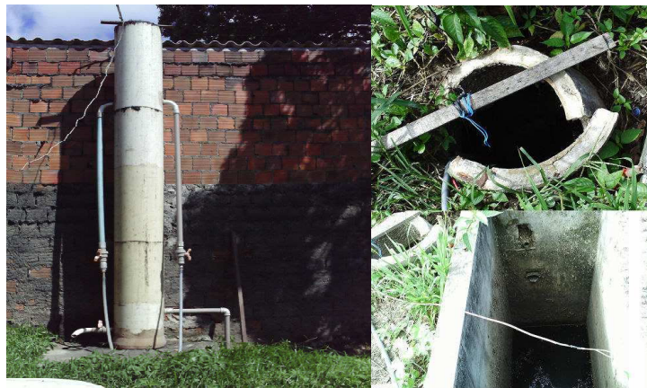
Figura 3.5: Foto da caixa de areia vertical e do poço de visita de onde o esgoto bruto era bombeado.
