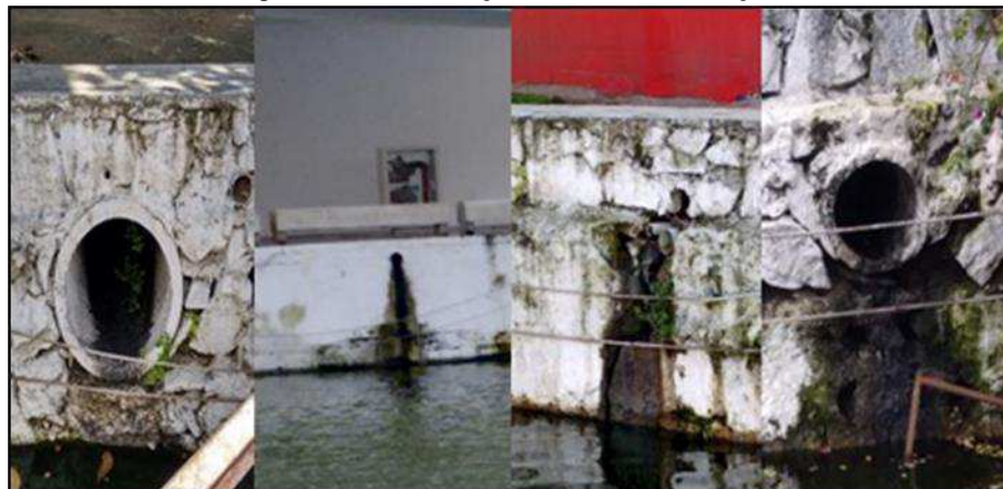
Figura 22 – Tubulações afluentes ao açude
