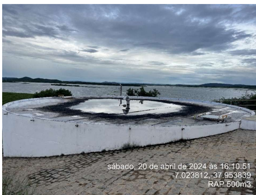
Figura 11 - Reservatório Apoiado de 500 m 3 (RAP 500 m 3 )
