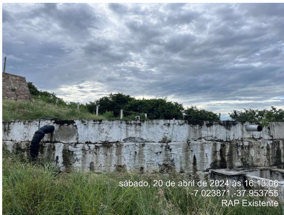
Figura 13 - Reservatório Apoiado 1 de 220 m 3 (RAP1 220 m 3 )
