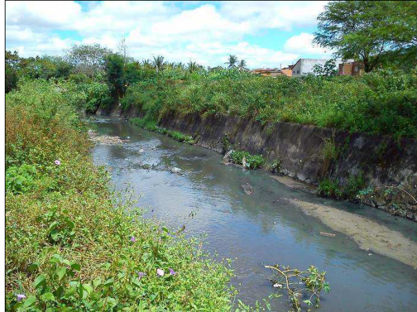
Figura 11 - Formação de bancos de areia no leito do Canal do Prado
