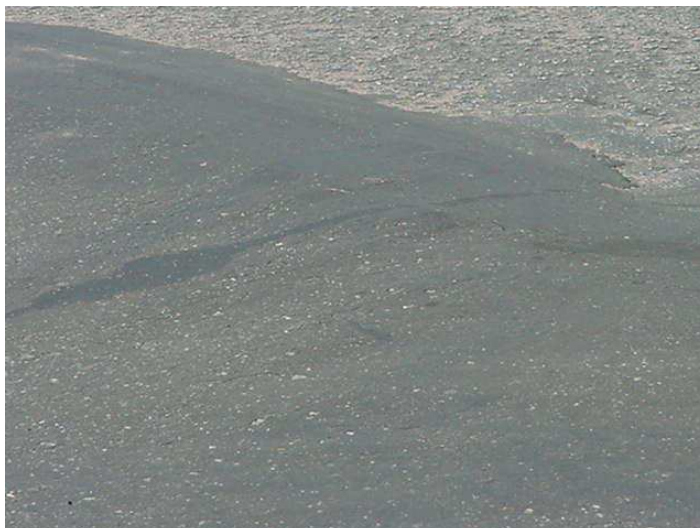
Figura 4 - Exsudação no revestimento
