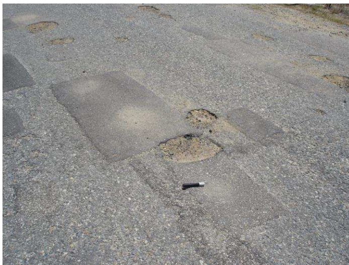
Figura 5 – Painéis de deterioração no revestimento
