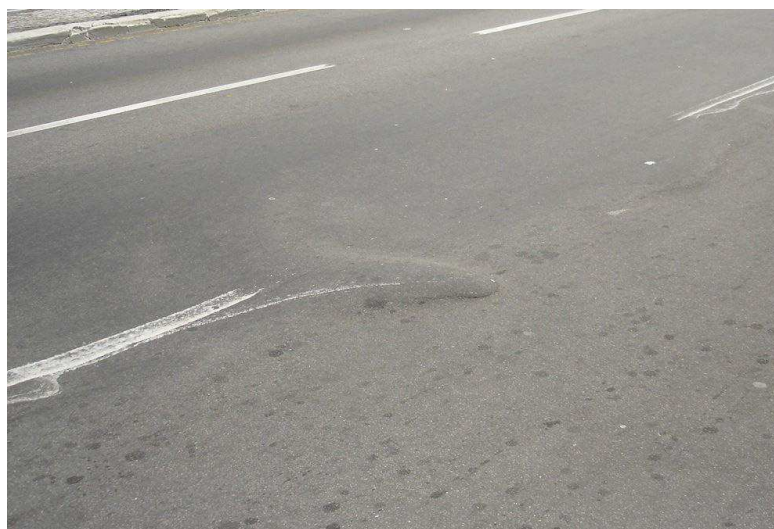
Figura 7 - Afundamento de trilha de roda
