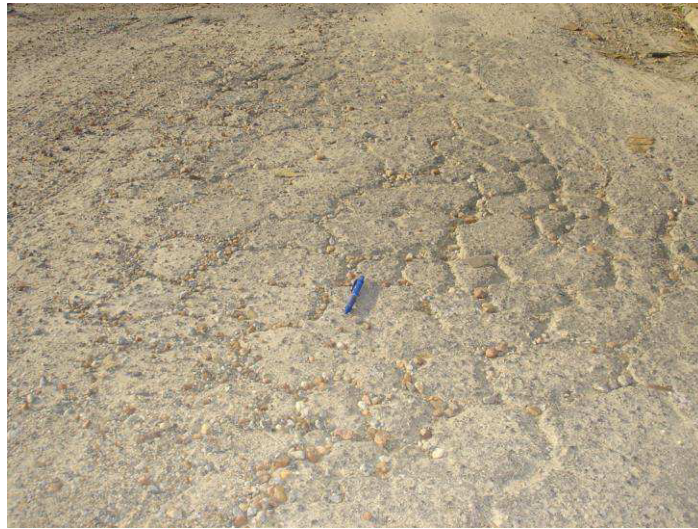
Figura 6- Desagregação no revestimento
