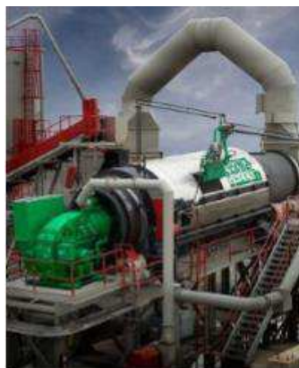
Figura 13 - Sistema Double Barrel® Green Instalado em Usina retirado de
