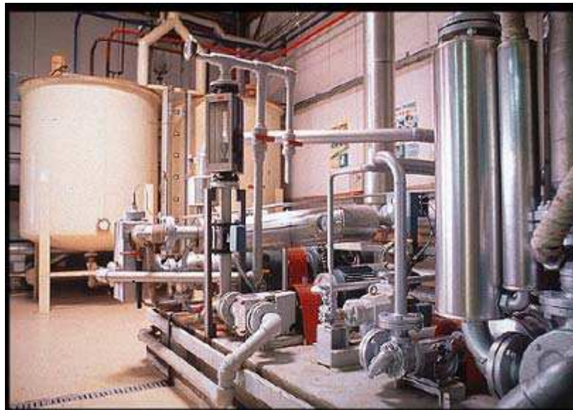
Figura 2.3 – Foto de instalações de uma fábrica de produção de emulsão asfáltica (adaptado de Nascimento, 2005).
