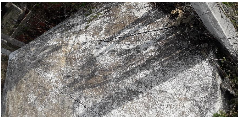
Figura 4: Cisternas danificadas. Fonte: Próprio autor, (2019)
