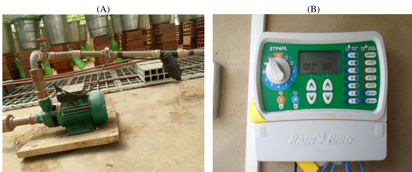
Figura 5 - Conjunto motobomba e filtro de disco (A) e painel digital para controlar o sistema de irrigação (B).
