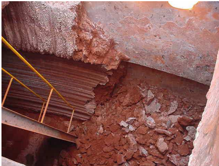
Figura 6 – Incrustação na parede do primeiro lavador
