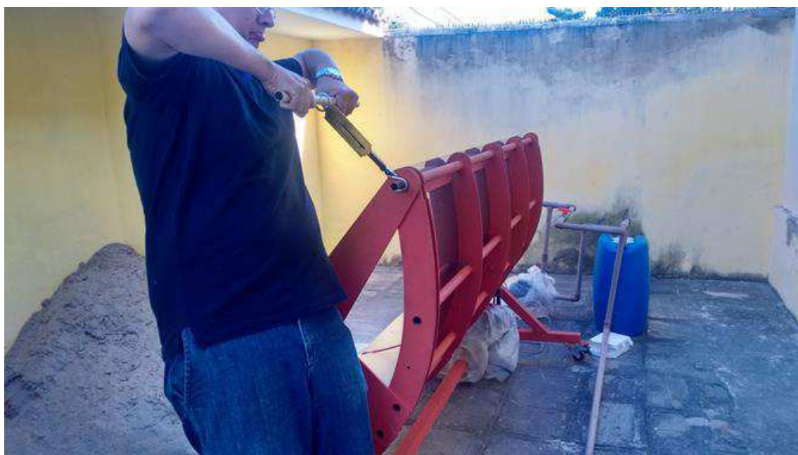
Figura 4.127 - Teste para a estimativa do torque necessário para a movimentação do coletor solar cilíndrico parabólico
