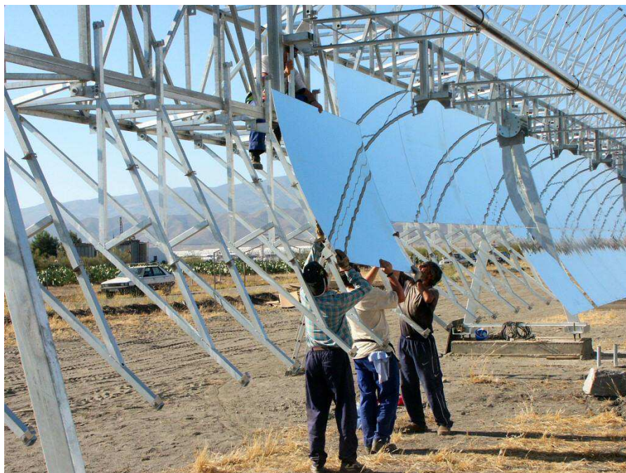
Figura 2.33 - Montagem de um coletor cilíndrico parabólico.
