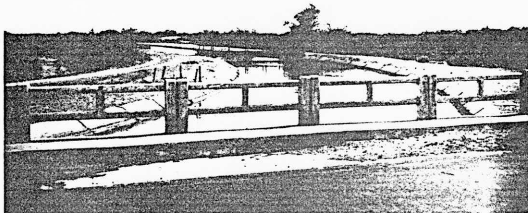
Foto n. 21. Canal principal, levando água para os canais secundários
