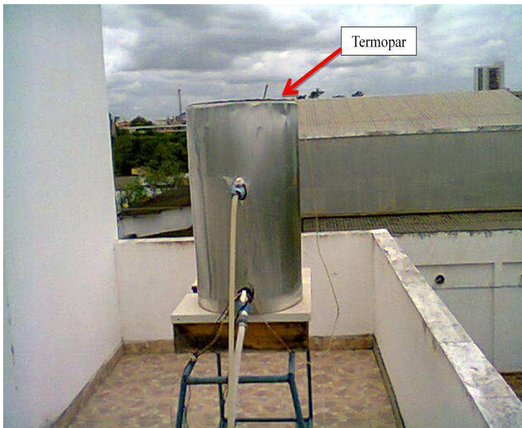
Figura 4.8 – Reservatório Térmico alternativo do sistema de aquecimento solar para a configuração I e configuração II.
