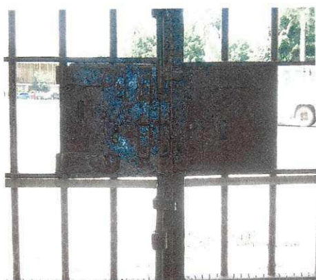
Figura 19e: fechadura do portão de entrada
