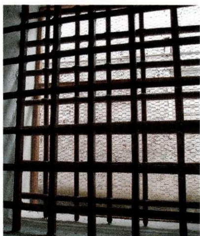
Figura 19a: Janela com duas grades Ferro
