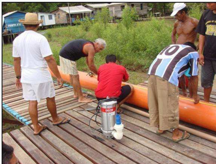
Figura 3.9 - Detalhe da tubulação para proteção e da bomba de captação
