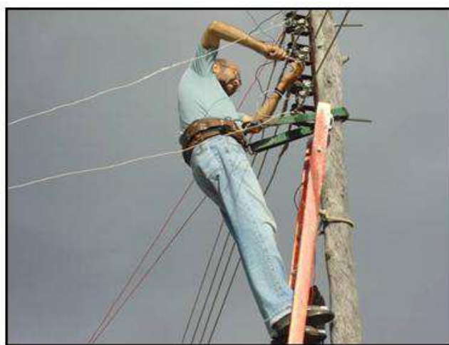
Figura 4.4 - Interligação com a rede elétrica da Vila
