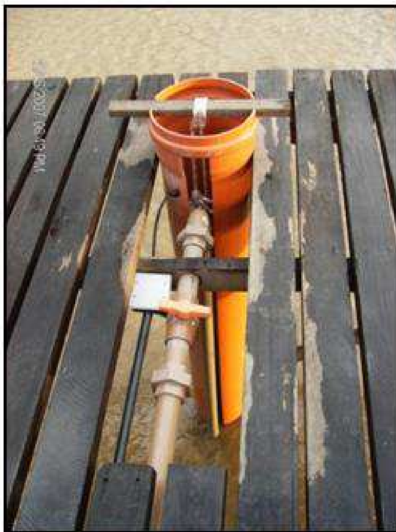
Figura 4.5 - Detalhe da Captação instalada
