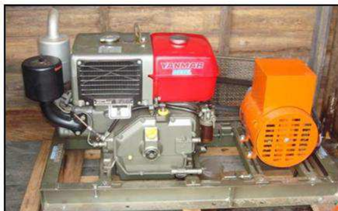
Figura 3.40 - Gerador diesel trifásico do sistema de dessalinização
