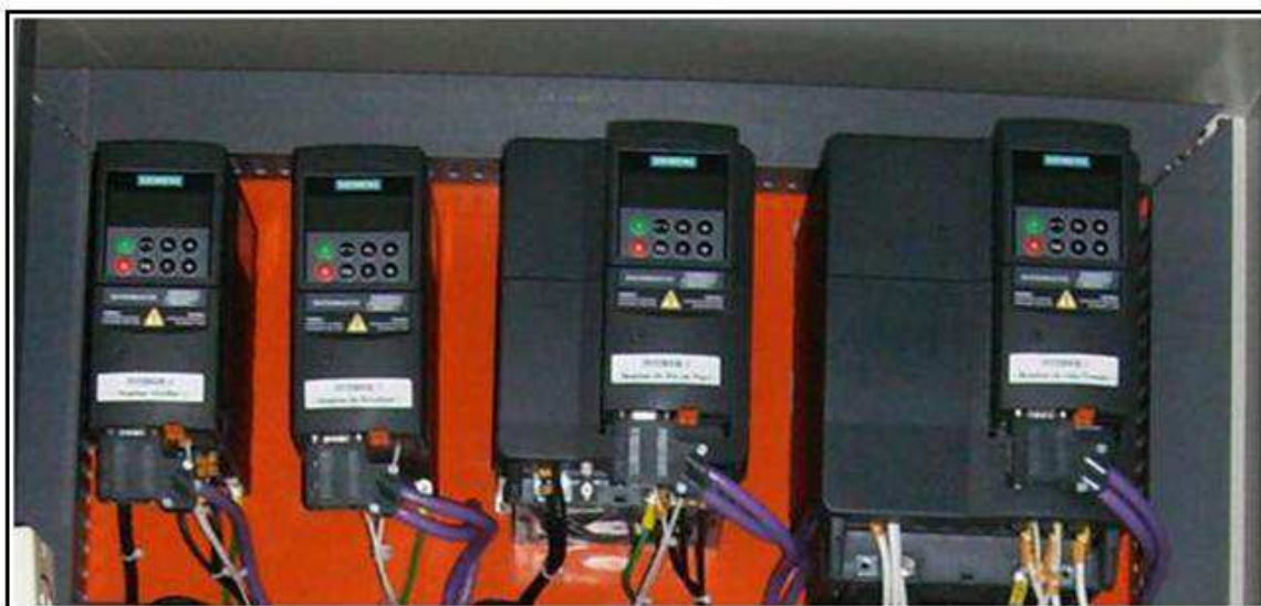
Figura 3.39 - Detalhe dos inversores no painel de automação
