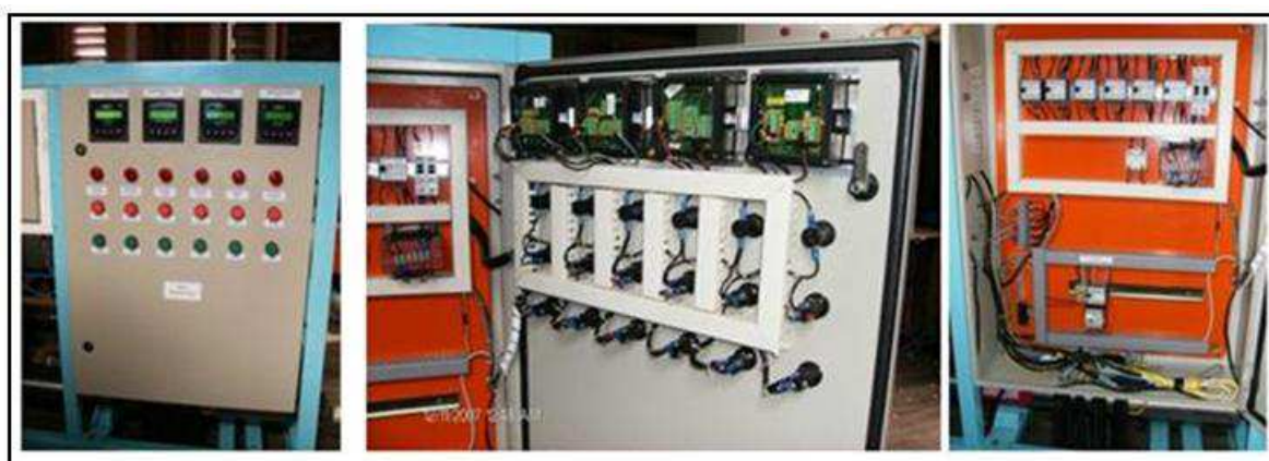
Figura 3.37 - Painel 2 - Painel de comandos das válvulas
