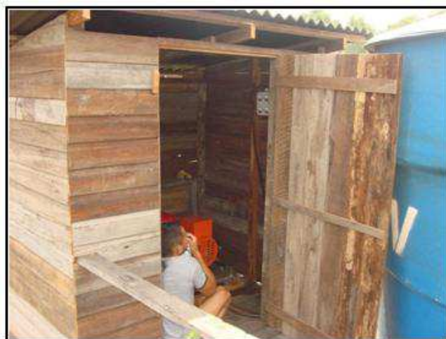
Figura 4.3 - Funcionamento do sistema com o gerador de 10 kVA
