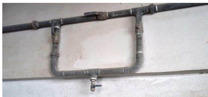
Figura 21 – Válvula utilizada na retirada de água das tubulações de ar comprimido
