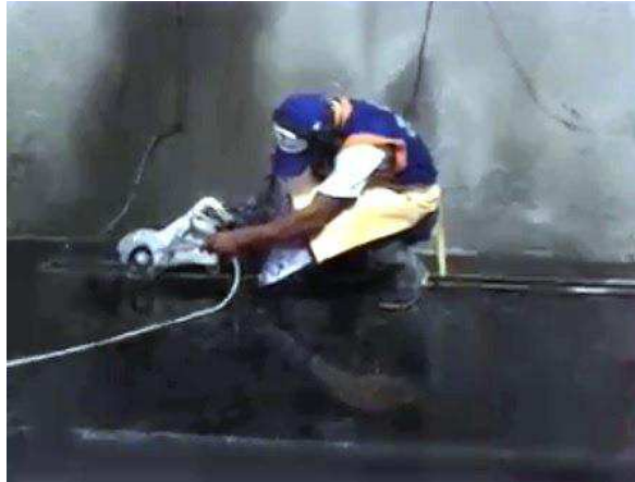
Figura 26 – Postura inadequada no uso da serra mármore para o corte da chapa
