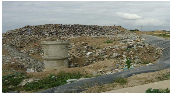
Figura 8 – Dreno de gás no aterro sanitário de Puxinanã-PB.
