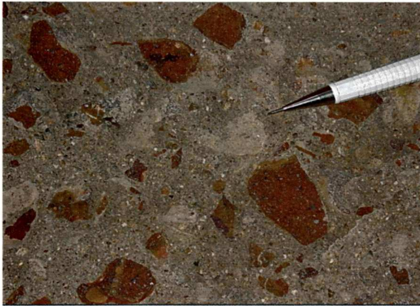
Figura 4.26: Vazios ocupados deixados pelos agregados na argamassa após o ensaio à tração indireta por compressão diametral.
