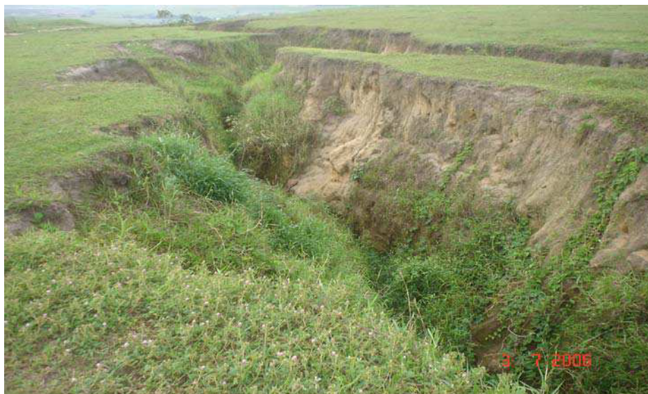
Figura 4.6 - Erosão na Zona Urbana em estado avançado. Fonte: Relatório Técnico. Prefeitura Municipal de Pedras de Fogo (2006).
