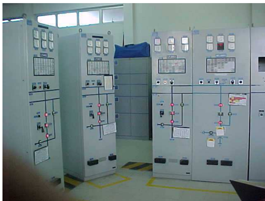
Figura 4.8 – Sala de painéis da subestação elétrica.
