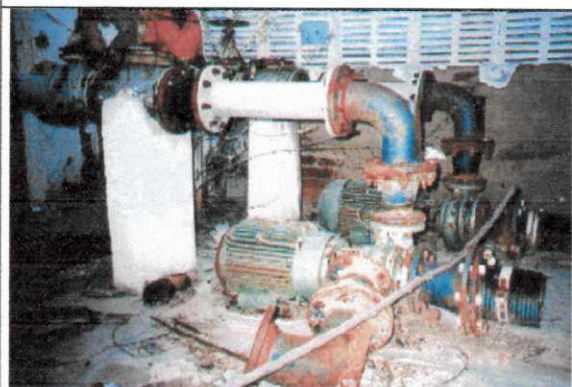
Figura 52. Estação de bombeamento sucateada (Projeto Canaã- Sumé )
