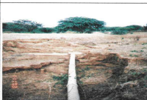
Figura 53. Sistema para adução e distribuição dágua abandonado (Proj. Canaã)
