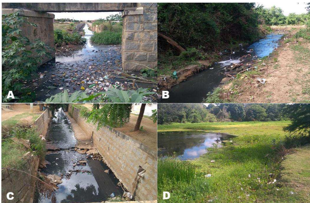
Foto 07. Disposição de resíduos sólidos nas imediações do Rio Piancó, no sistema de drenagem pluvial e nos cursos dos esgotos.
