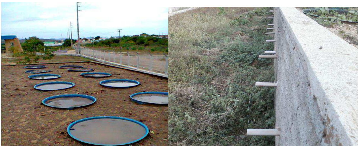
Figura 3. Aplicação de água para o processo de acomodação do solo (A), imagem da drenagem da água (B).
