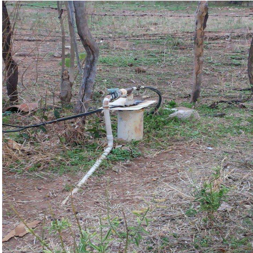
Foto 9: Poço artesiano de uma das famílias da comunidade, MOTA (2017).
