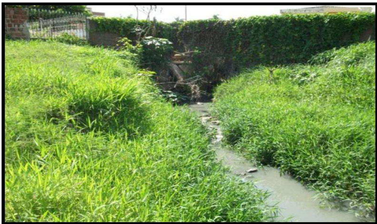
FOTO 13 – Rede de galerias pluviais distribuídas nas margens do Açude Grande – Avenida Pedro Moreno Gondim
