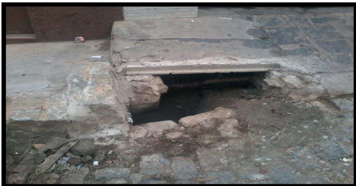
FOTO 15 - Redes de galerias pluviais destinadas as águas do Açude Grande – Rua Sete de Setembro
