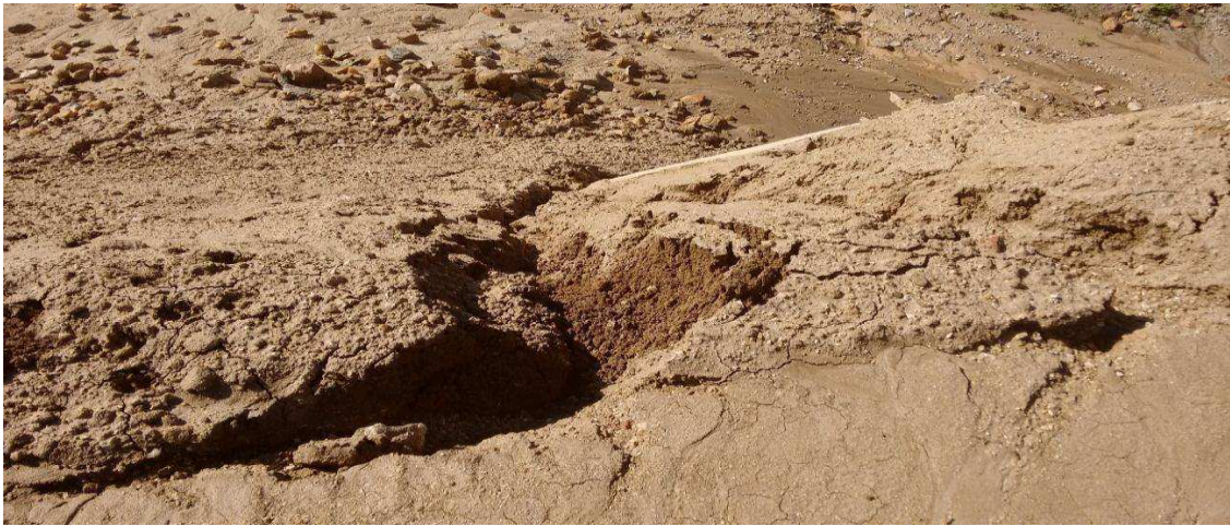
Figura 10: Processos erosivos em taludes no trajeto da rodovia PB-200. Fonte: Santos, 2015.
