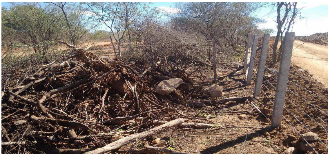
Figura 14: Matéria orgânica proveniente da remoção da cobertura vegetal na rodovia PB-200. Fonte: Santos, 2015.
