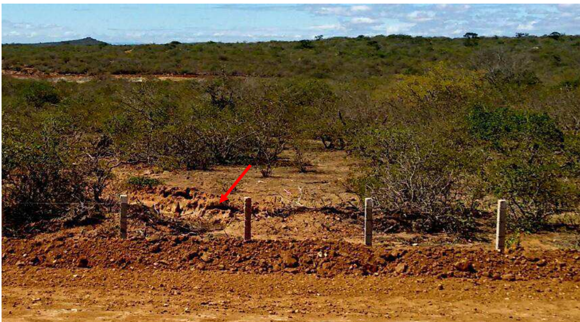
Figura 11: Processo erosivo em área adjacente a rodovia PB-200. Fonte: Santos, 2015.
