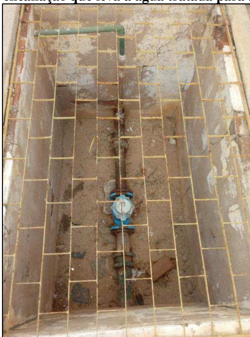
Imagem 07: Registro e encanação que leva a água tratada para a rede de distribuição
