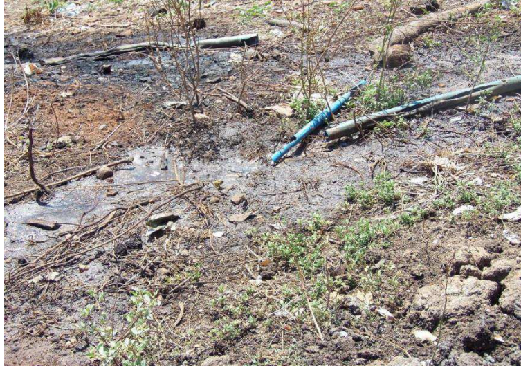
Figura 11 - Lançamento de águas residuárias a céu aberto
