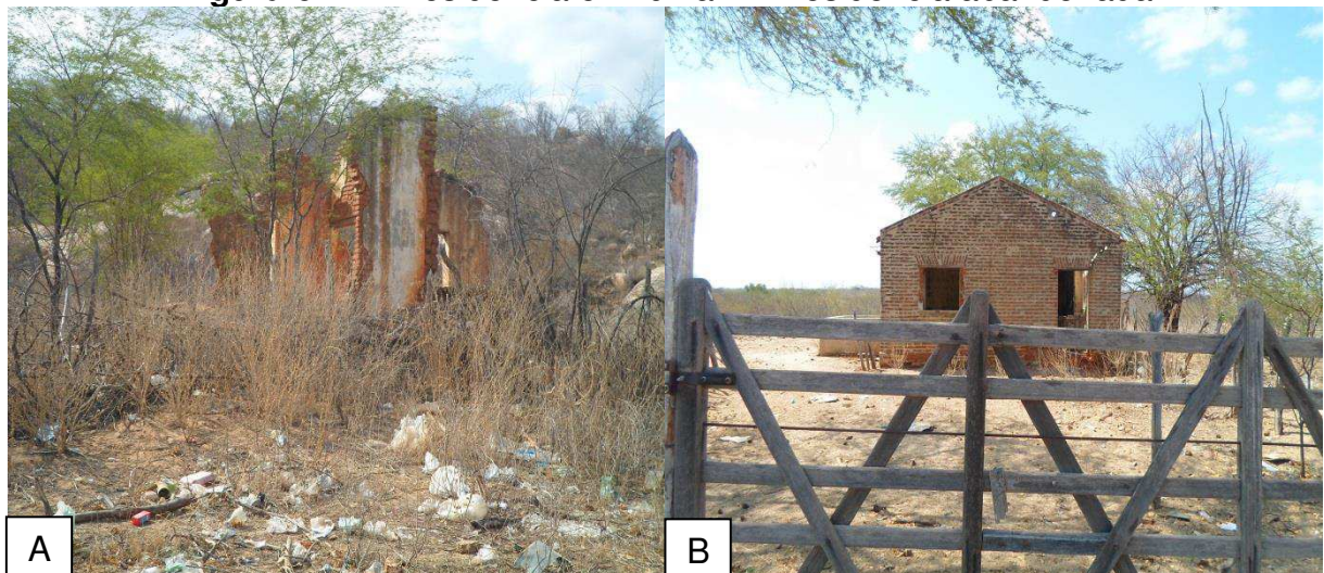
Figura 6 – A. Residência em ruína. B. Residência abandonada
