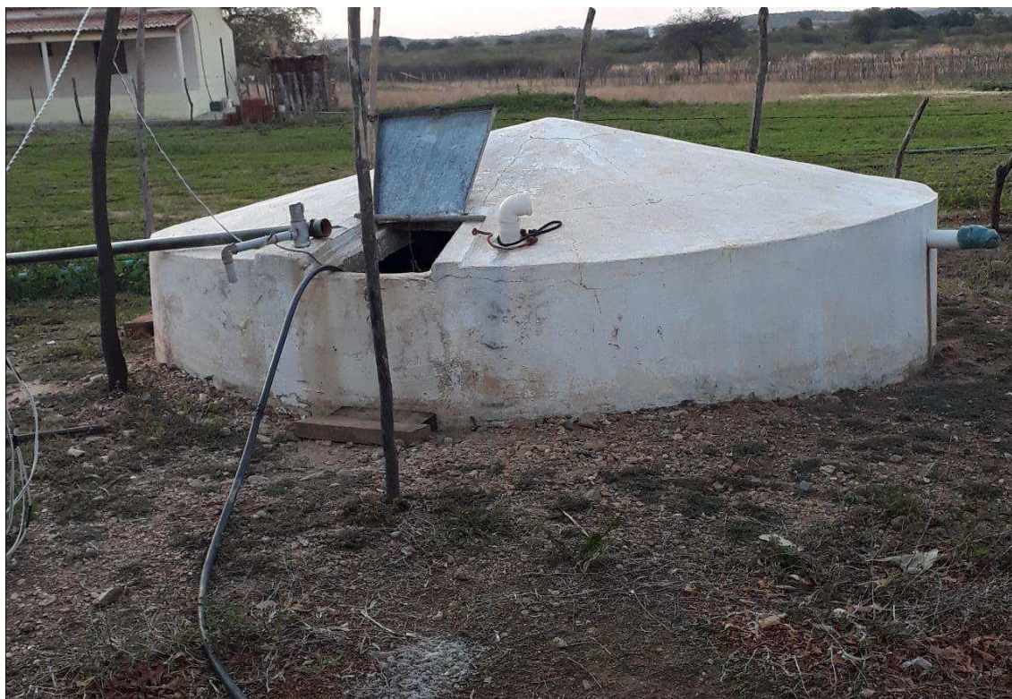
Figura 8– Cisterna de placa
